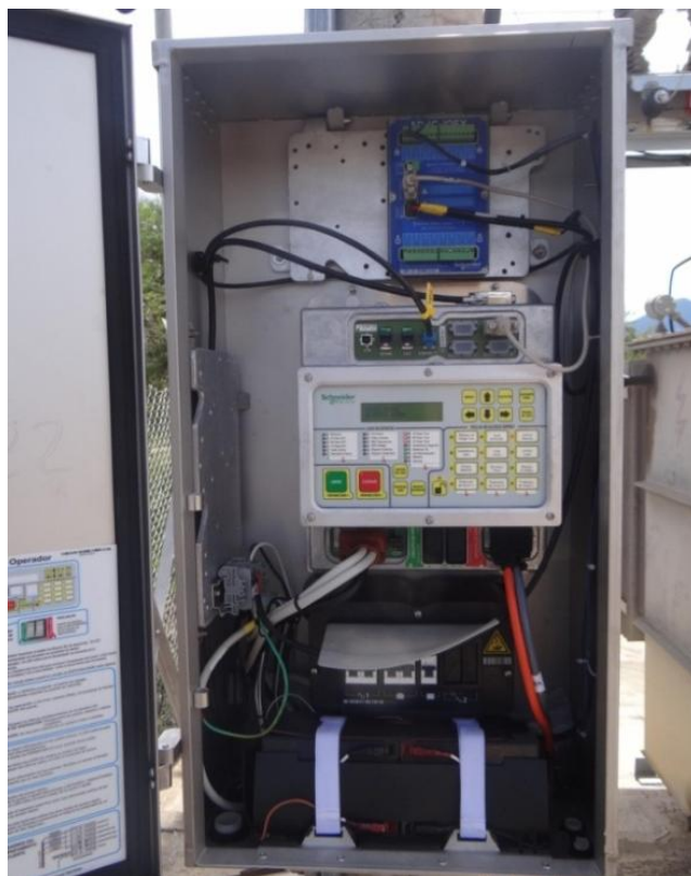
Figura 25. Re-conector en subestación
