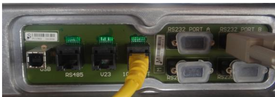
Figura 16. Puertos de comunicación re-conector NU-LEC.
