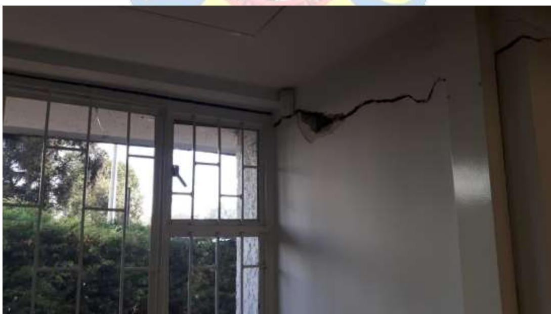
Imagen 17. Grietas en muros interiores Fuente: Autor
