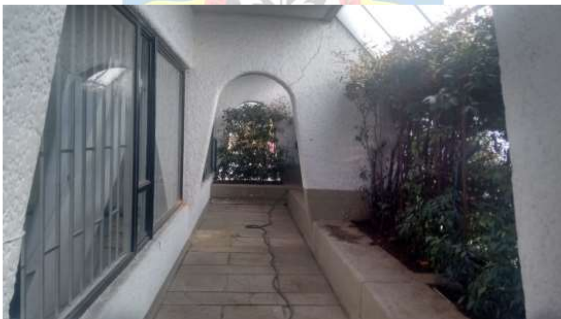
Imagen 36. Fisuras en Muros de Mampostería Trapezoidales Fuente: Autor
