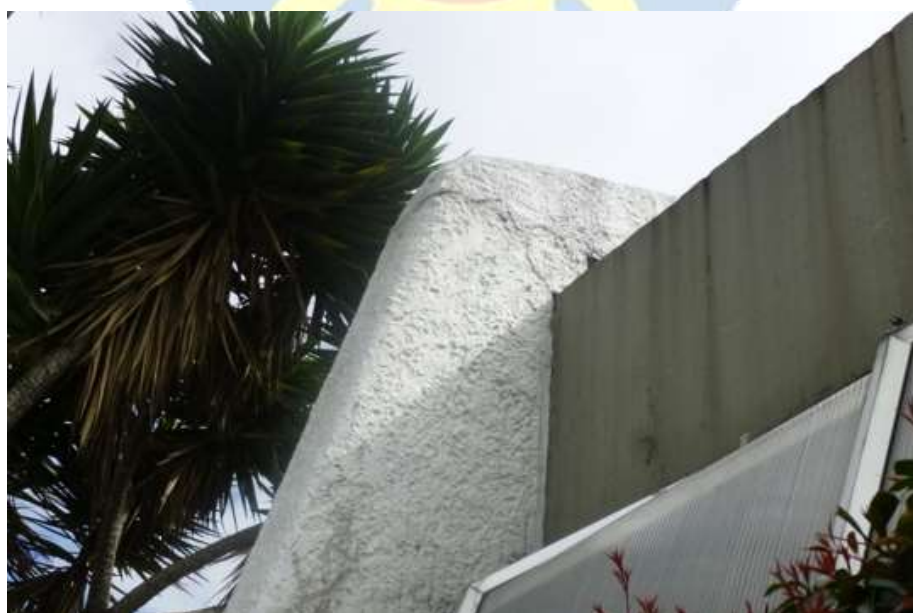
Imagen 62. Evidencia de Fisuras en Elementos de Cubierta Fuente: Autor
