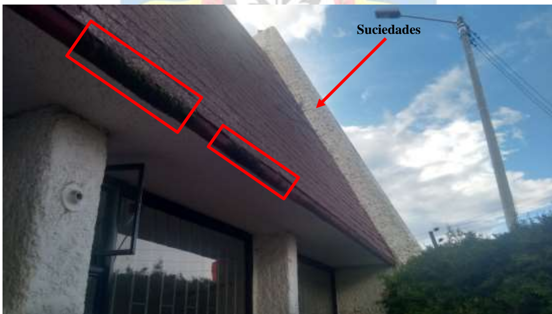
Imagen 11. Presencia de líquenes y suciedades en elementos de cubierta Fuente: Autor
