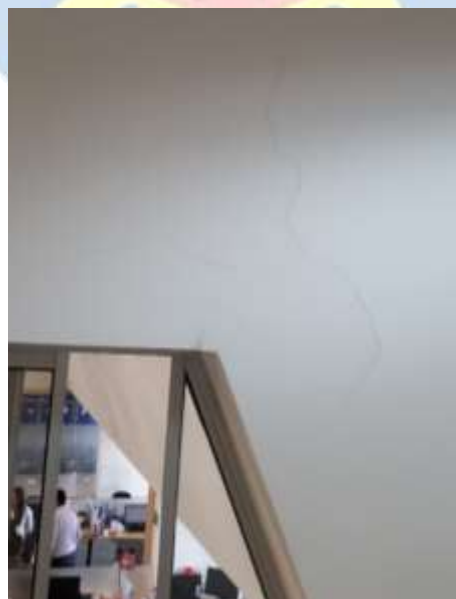
Imagen 19. Fisuración en muros del segundo piso Fuente: Autor
