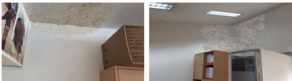
Imagen 15. Humedad por filtración Fuente: Autor
