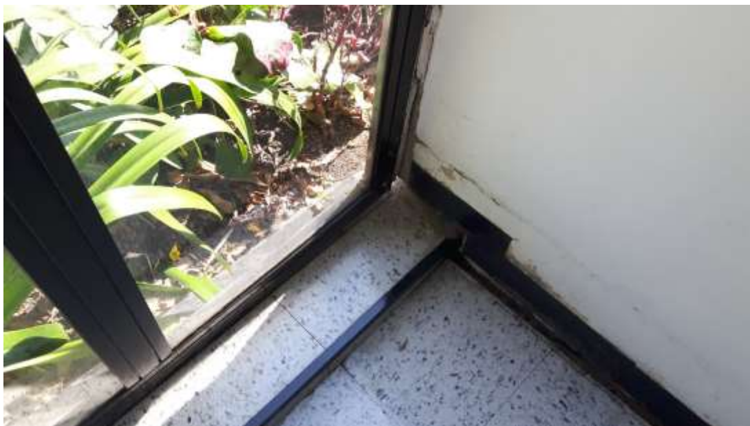
Imagen 37. Evidencia de Asentamientos Fuente: Autor
