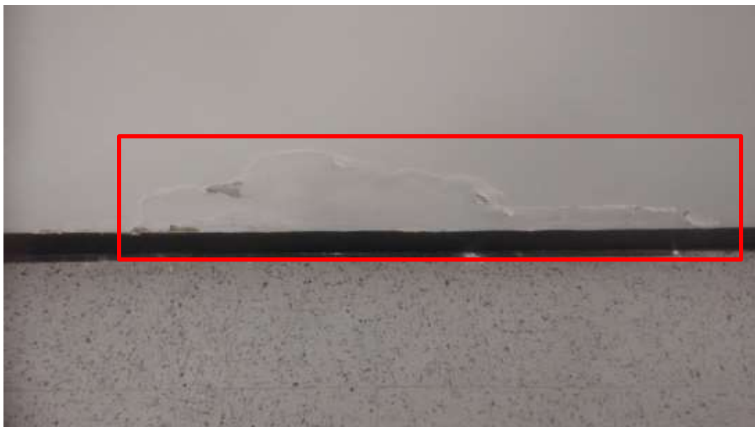
Imagen 10. Descasramientos de pintura presencia de humedad Fuente: Autor
