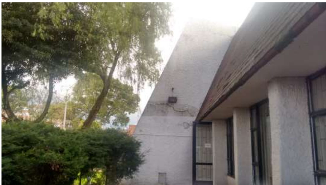
Imagen 35. Evidencia de Fisuras en Elementos Estructurales Fuente: Autor
