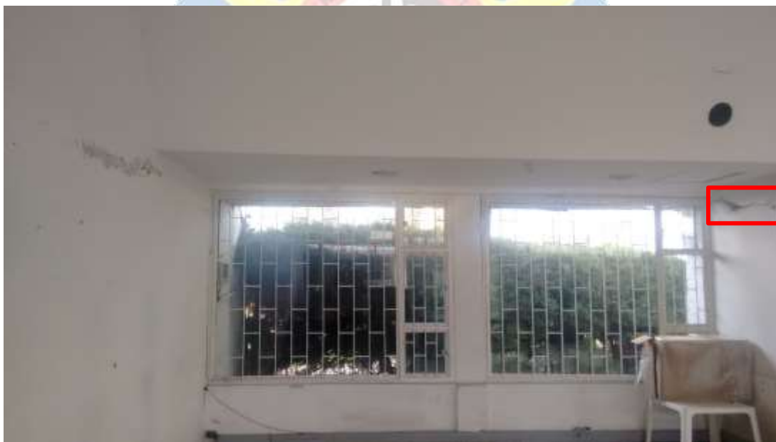
Imagen 9. Evidencia de Grietas en Oficina Abierta del Primer Piso Bloque 2 Fuente: Autor
