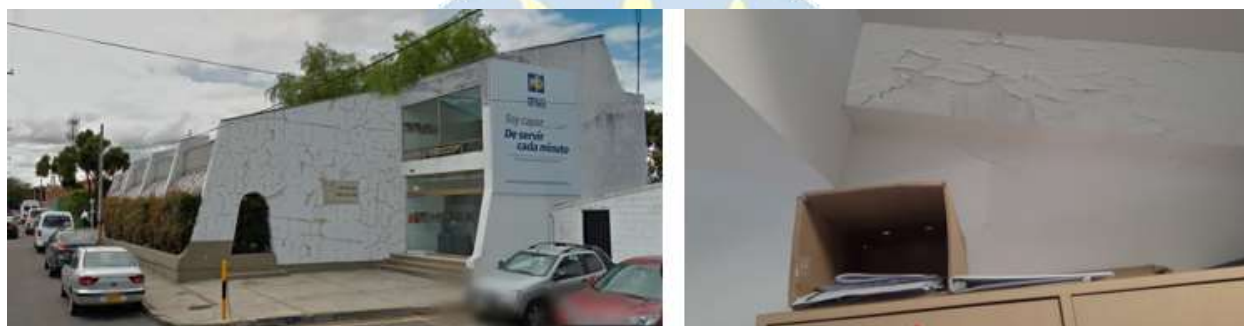
Imagen 14. Humedad por falta de mantenimiento Fuente: Autor
