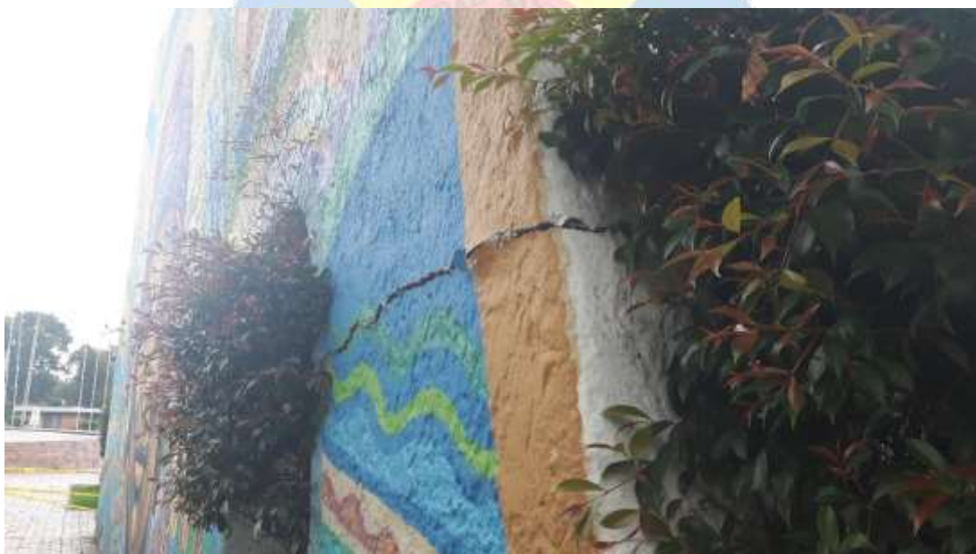
Imagen 38. Grietas en Elementos Estructurales Fuente: Autor
