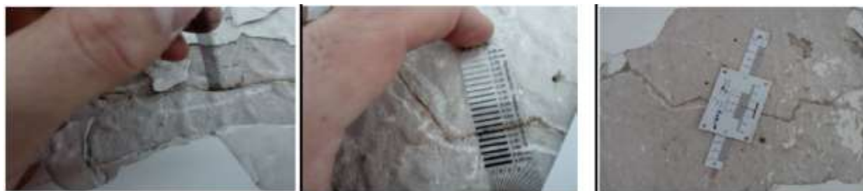
Imagen 56. Ensayo Determinación de Fisuras Fuente: Autor
