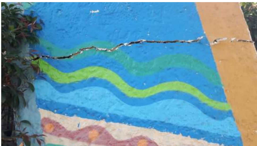
Imagen 16. Grietas en muros exteriores Fuente: Autor
