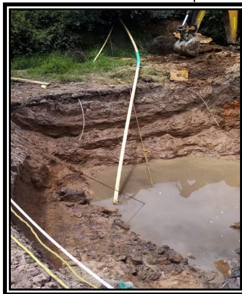
Figura 26. Presencia de Nivel freático en excavación de sistema séptico
