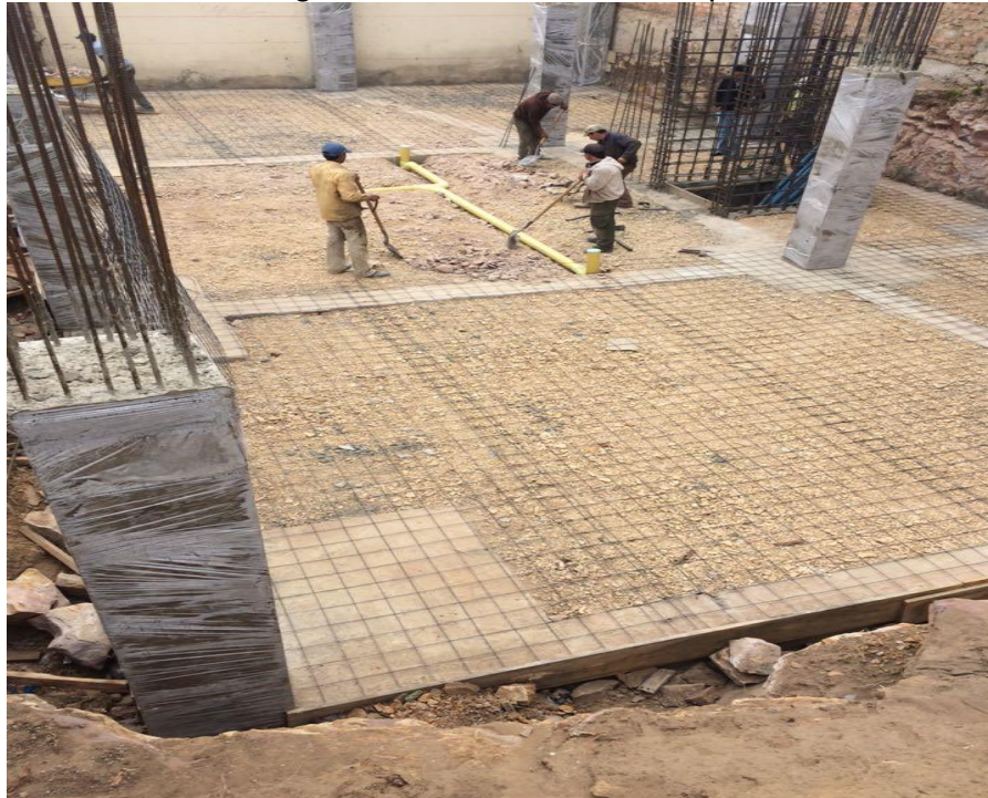
Fotografía 11. Placa de contrapiso.
