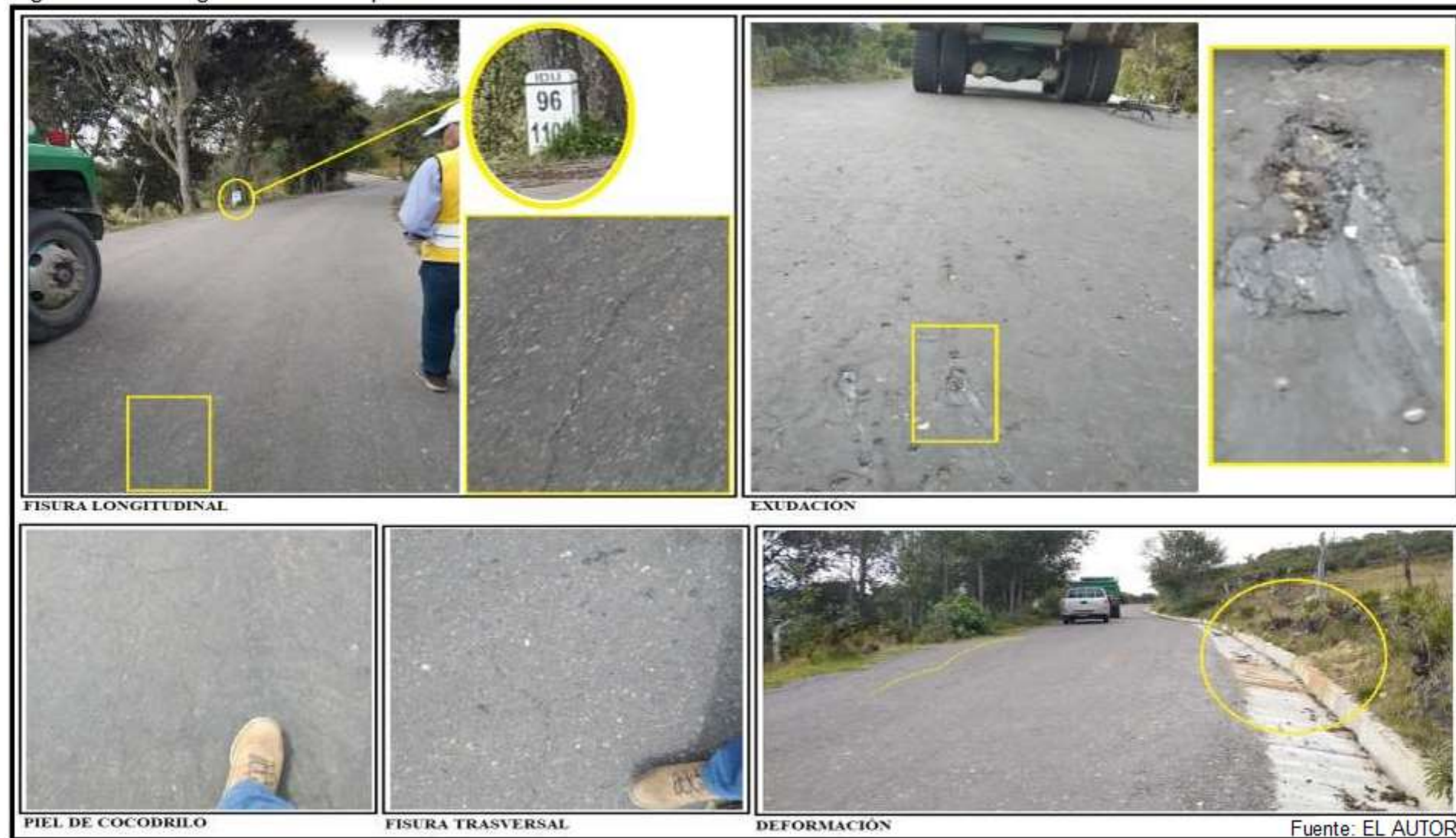
Figura 39. Patologías de daño superficial.
