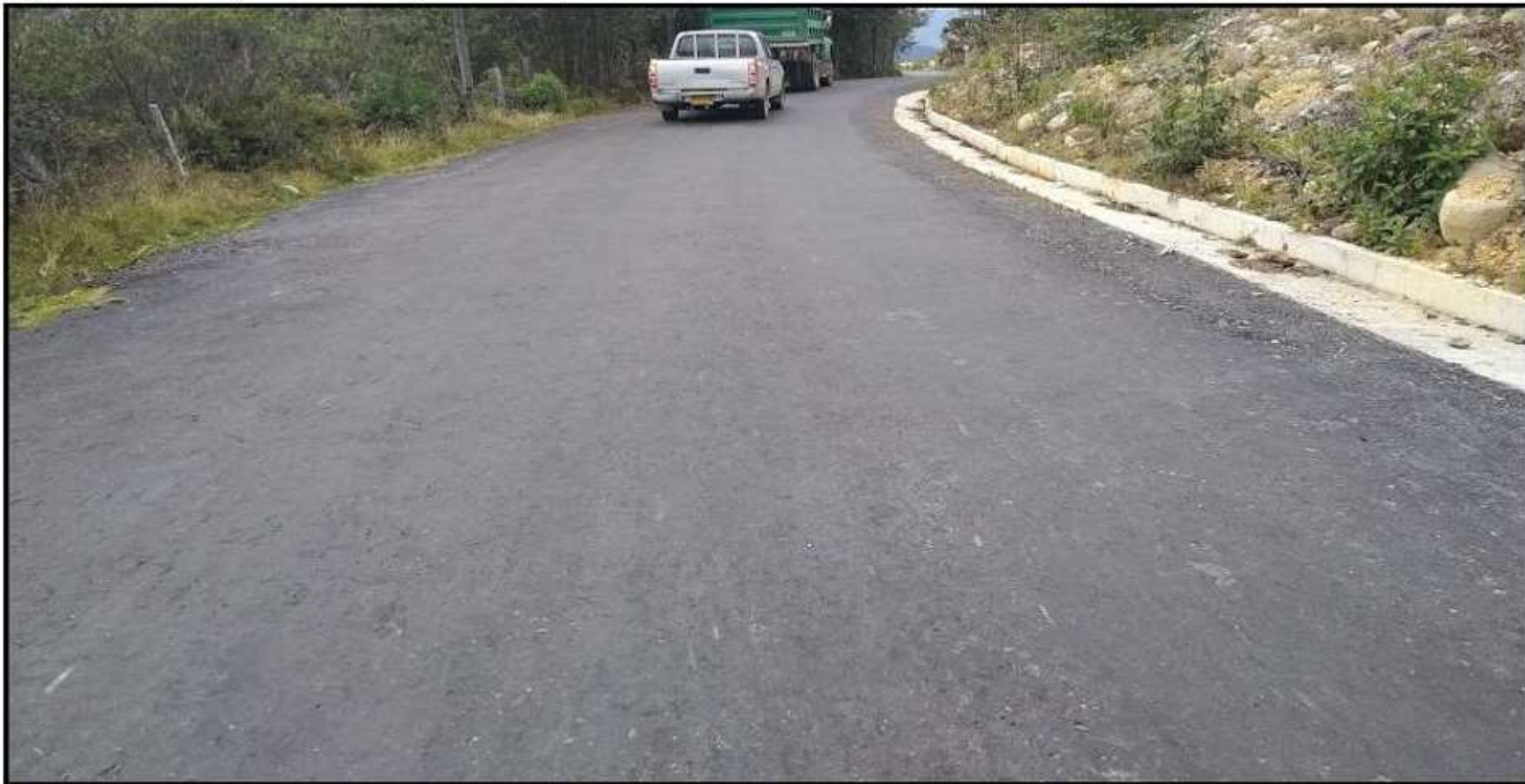
Figura 42. Aspecto general de la regularidad superficial del pavimento.
