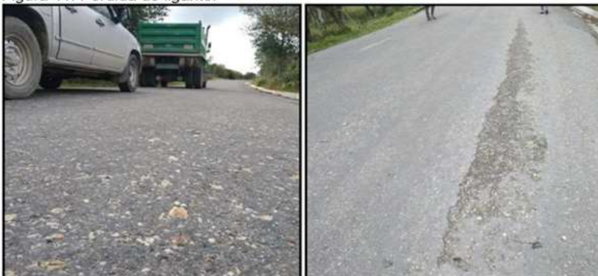
Figura 41. Pérdida de ligante.
