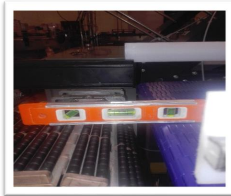
Figura 25. Brecha del Puente de Transferencia de la línea uno frente a transportador nuevo.
