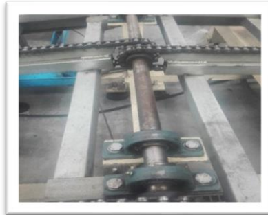
Figura 17. Eje central de despaletizado del sistema de transporte uno con problema corrosión y oxido.
