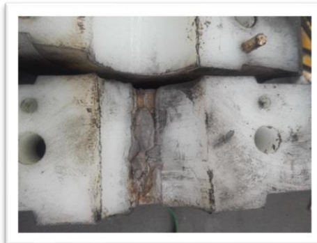
Figura 14. Engranaje con desgaste y fractura por corrosión en línea uno.
