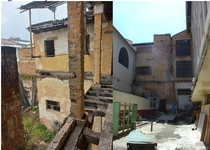
Figura 6. Inspección visual inicial – levantamiento
