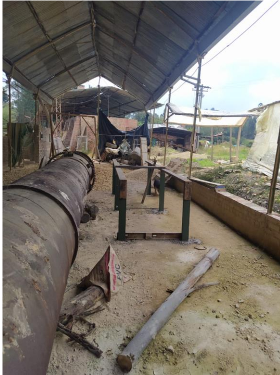
Figura 23: Montaje horno Fuente: propia
