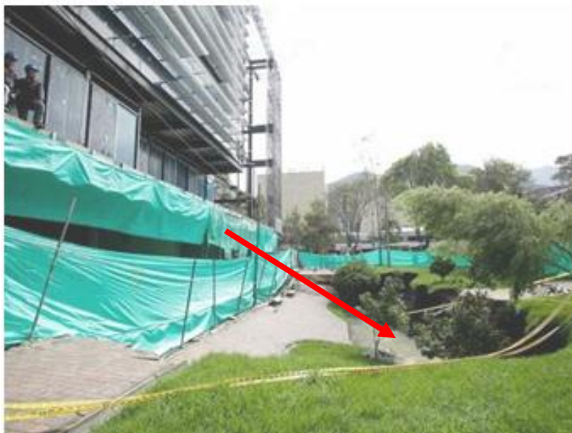
Figura 5. Fallas en superficie edificio Green Office
