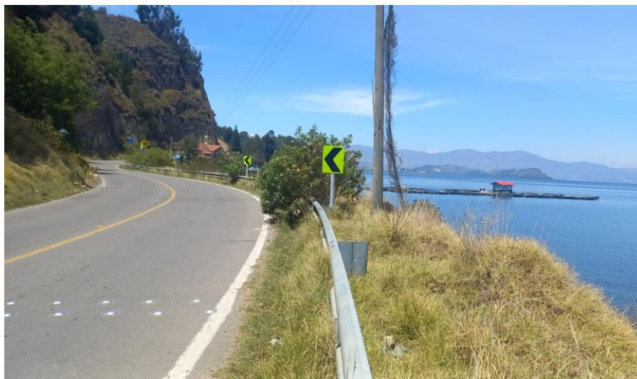
Figura 14. talud vía Aquitania- Sogamoso
