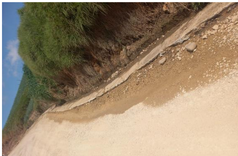
Figura 5. Humedad en base granular
