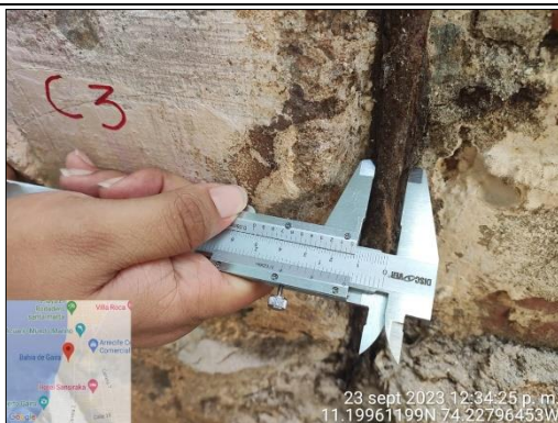
Lectura de diámetro promedio de barra longitudinal de refuerzo en columna C2.
