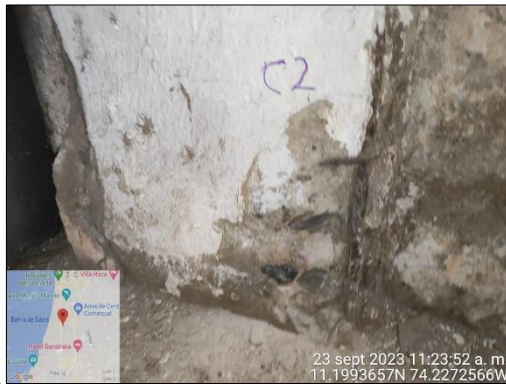
Prueba del PH de concreto con ensayo de Carbonatación en columna C2.
