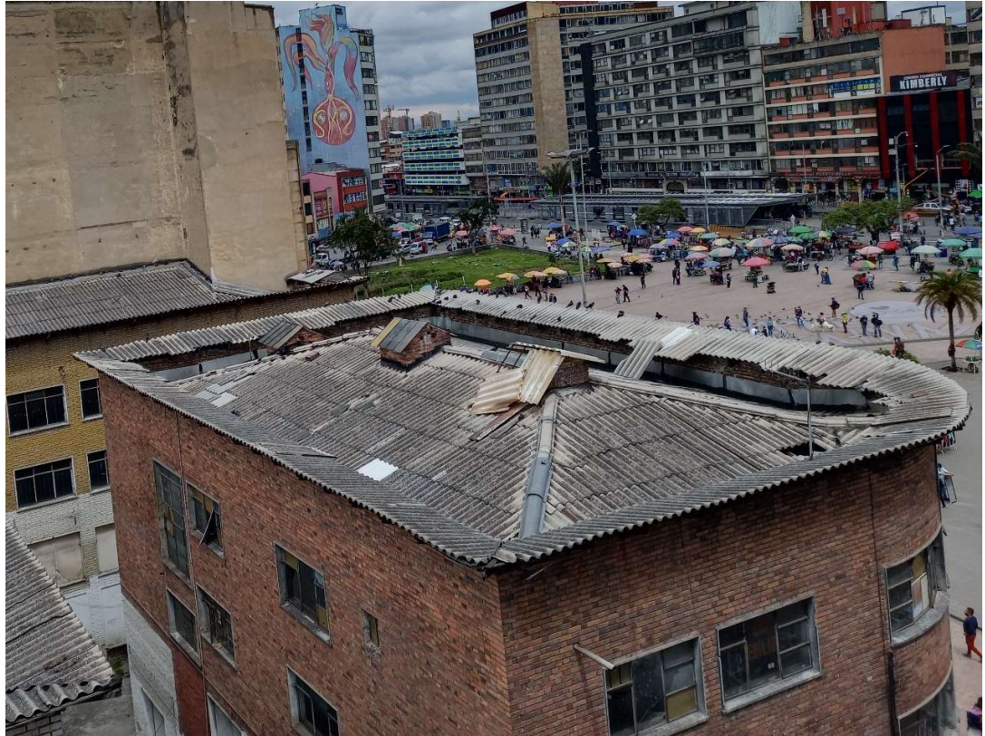
Fotografía 3, Casas, A., & Hernández, C. (2023). Estado de la cubierta edificio A. (Fotografía digital)
