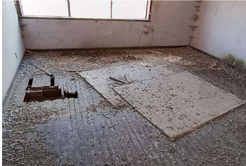
Fotografía 13, Casas, A., & Hernández, C.(2023) Estado de la madera entrepiso. [Fotografía digital].
