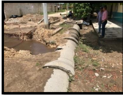
Imagen 24. Rotura de tubo de alcantarillado de 36 pulgadas de concreto para minimizar la fuga de agua potable.
