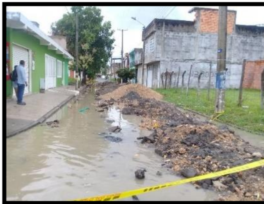
Imagen 56. Inundación de excavación por fuertes lluvias.
