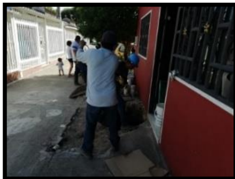
Imagen 58. Sondeo mecánico en caja de inspección obstruida.
