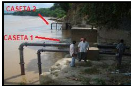
Imagen 12. Tuberías que funcionan por succión que dirigen el agua cruda a la caseta 1 y caseta 2.
