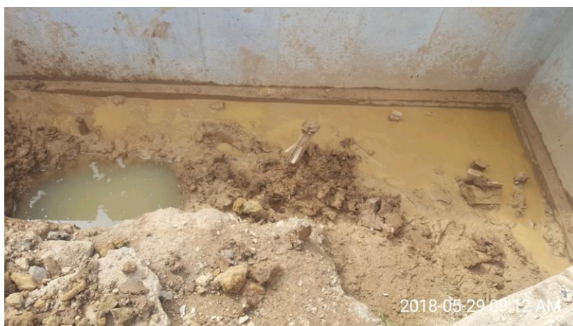
Figura 46. Escorrentía presentada en Torre 2 detrás de muro de contención
