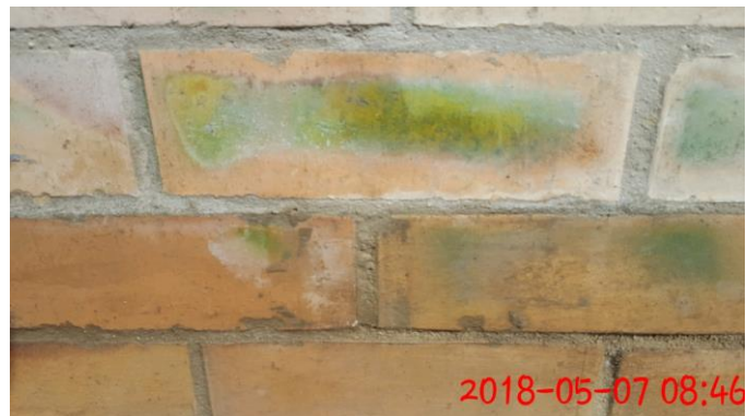
Figura 38. Mancha presentadas en las unidades de mampostería
