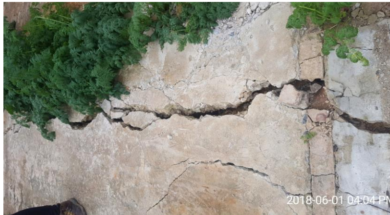
Figura 45. Grietas presentadas en la terraza Torre 4
