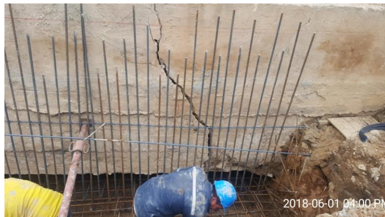
Figura 44. Grietas en los muros vetustos
