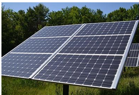
Figura 6. Módulos Fotovoltaicos / Paneles Solares
