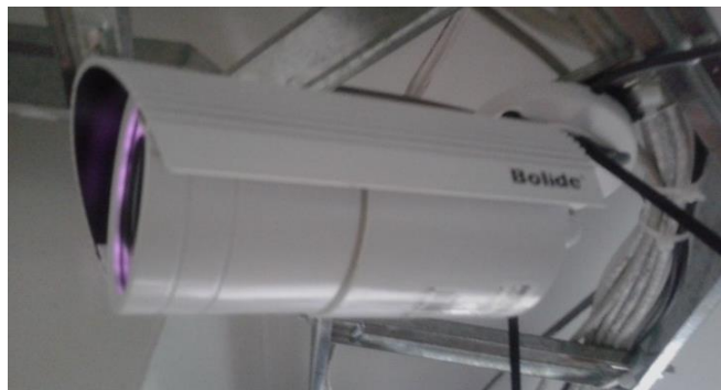
FIGURA 33. CAMARA DE SEGURIDAD- SERVIBOY LTDA
