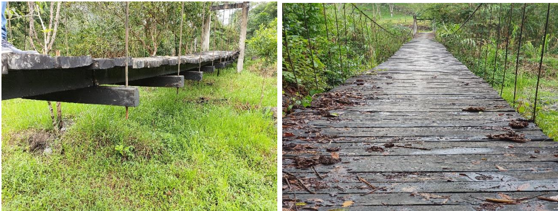
Imagen 3: Estado actual puente colgante vereda puerto parra.
