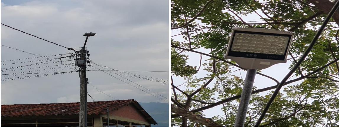
Imagen 6: Alumbrado público de la zona urbana.
