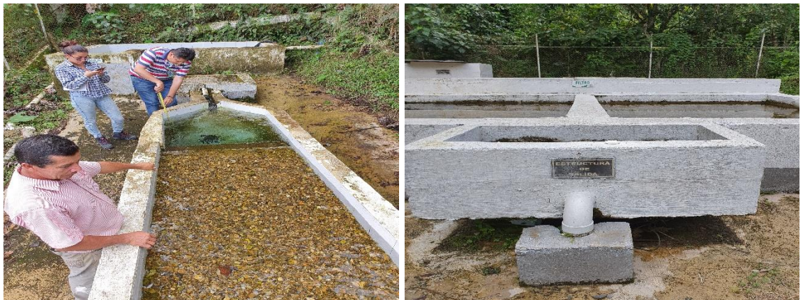
Imagen 7: Planta de tratamiento agua potable.
