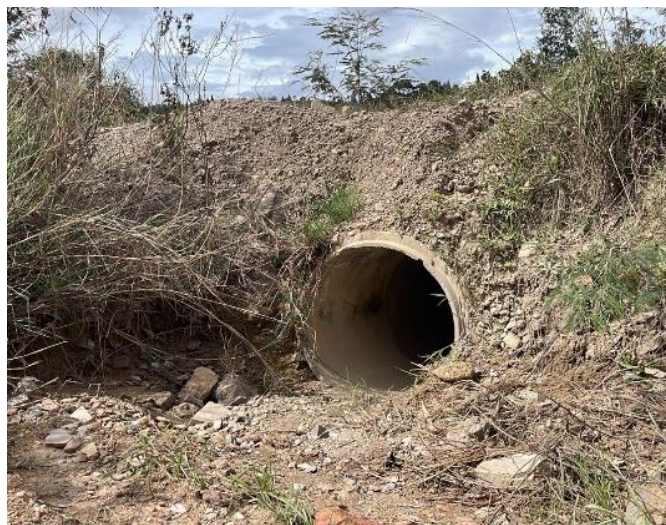
Imagen 31: ubicación de alcantarillas pluviales 1.
