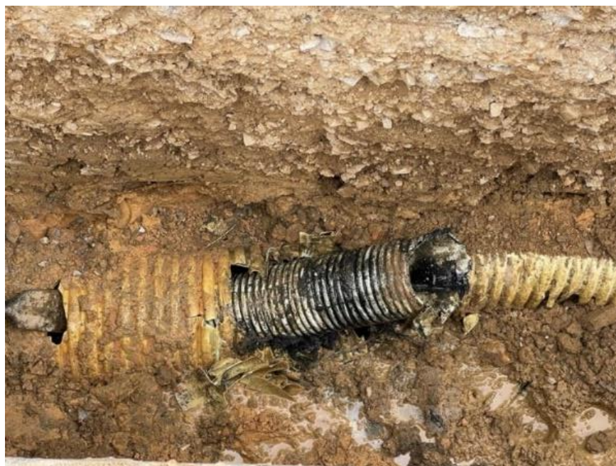
Imagen 51: Detección de problemas en tubería existente.
