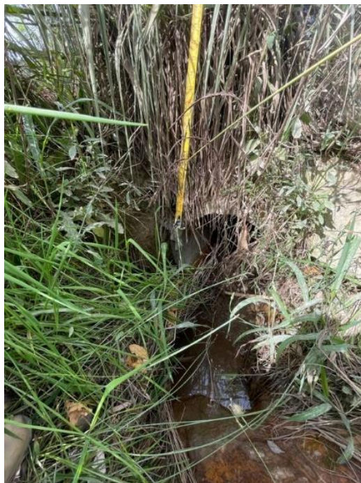
Imagen 32: ubicación de alcantarillas pluviales 2
