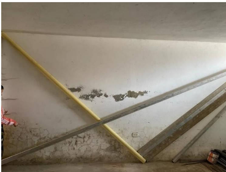
Imagen 47: Inspección de viviendas afectadas.
