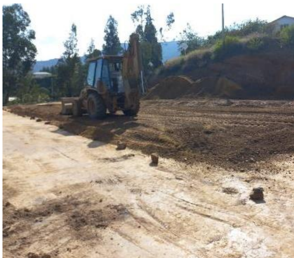
Imagen 5:Extendida, colocación y compactación de material para afirmado para el mejoramiento de la estructura de cimentación del cerramiento.
