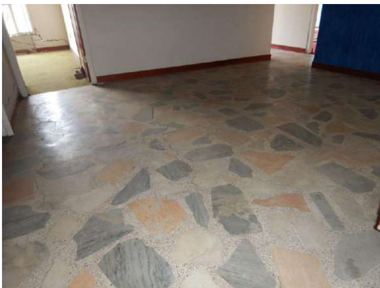
Figura 4. Segundo piso, Grieta en placa de entrepiso tercer piso. Fuente: Propia.
