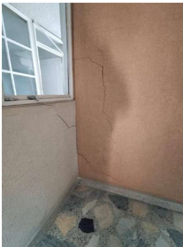
Figura 10. Fisuras presentes en muros de la planta de segundo piso. Fuente: Propia
