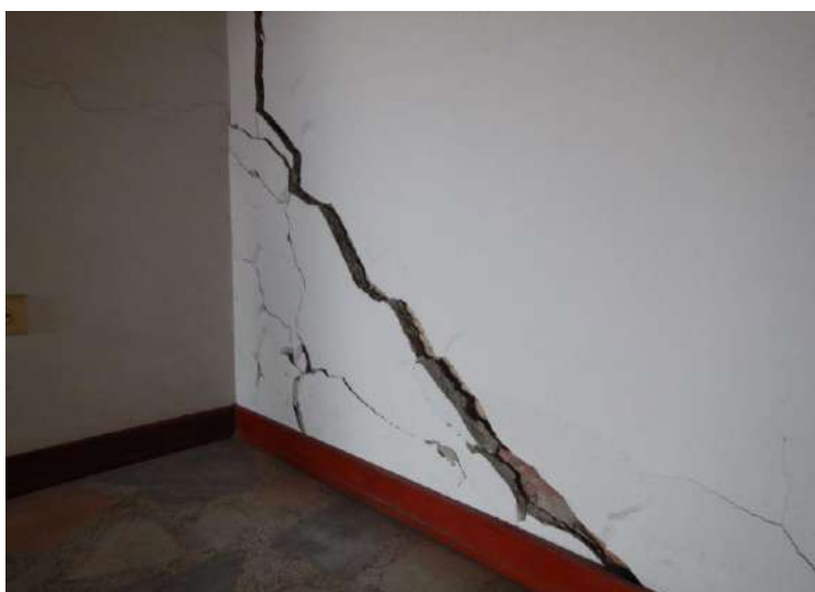
Figura 5. Grieta en cortante presente en muro divisorio de segundo piso. Fuente: Propia.
