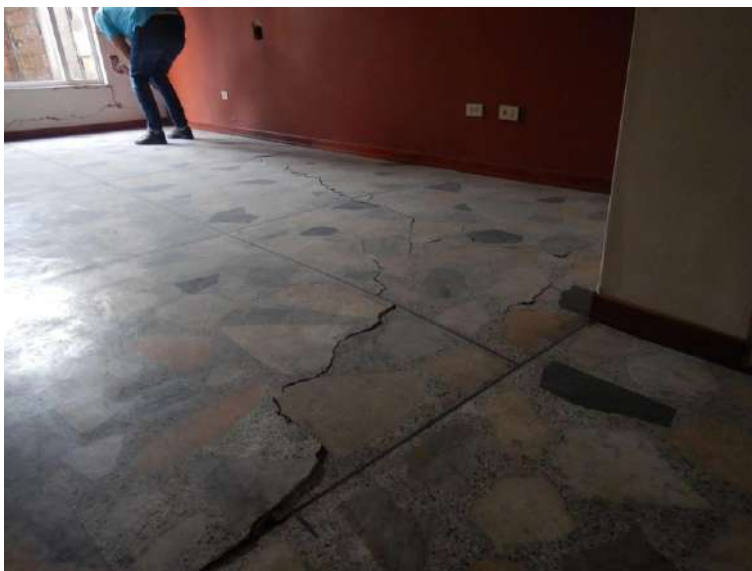
Figura 3. Grieta en placa de entrepiso segundo piso. Fuente: Propia.
