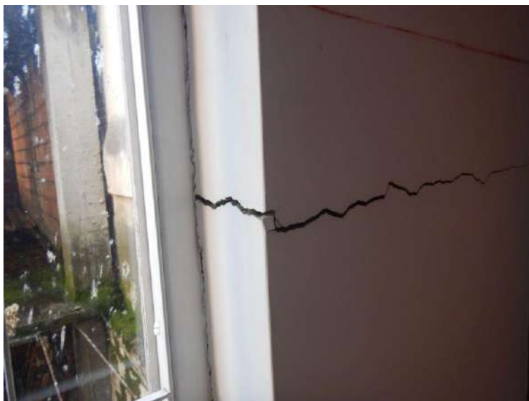
Figura 9. Grieta interna de fachada posterior en segundo piso. Fuente: Propia
