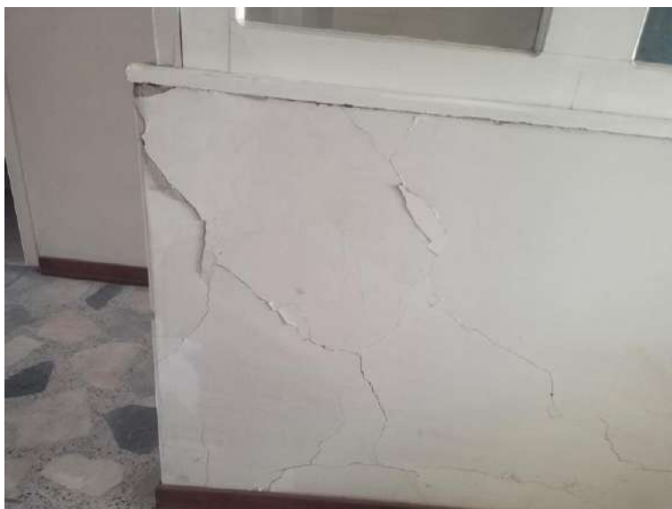
Figura 8. Fisuras en antepecho interno. Fuente: Propia.
