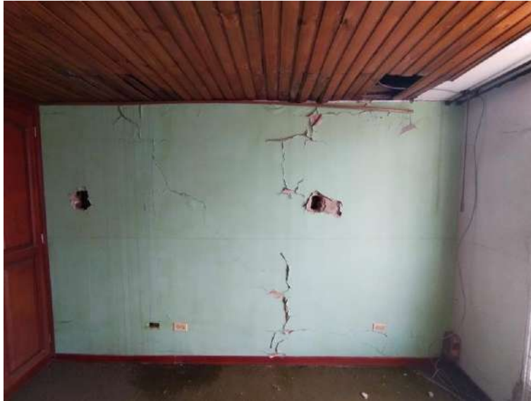
Figura 12. Humedad por filtración tercer piso. Fuente: Propia.
