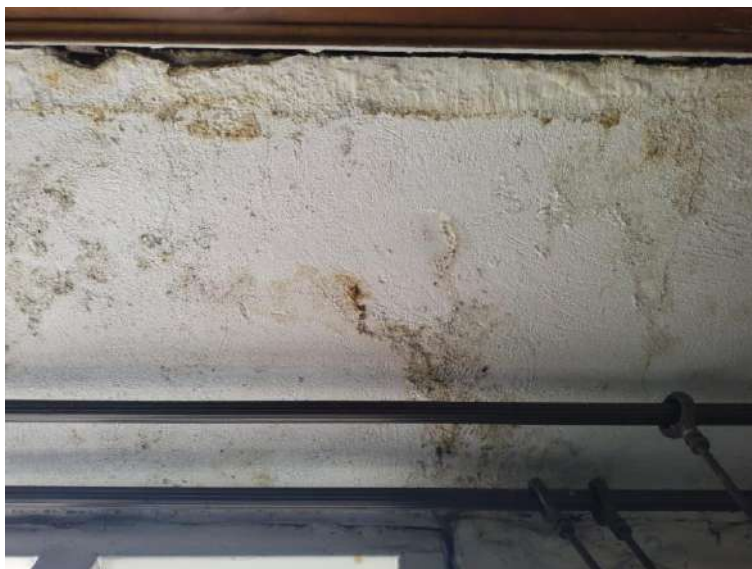
Figura 11. Humedad por filtración. Fuente: Propia
