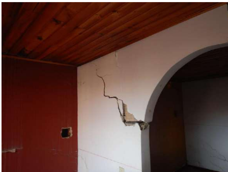
Figura 6. Grieta en cortante presente en tabique de tercer piso. Fuente: Propia.
