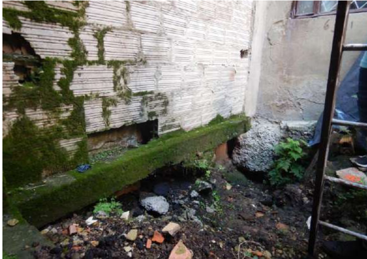
Figura 13. Presencia de capa vegetal y socavación. Fuente: Propia
