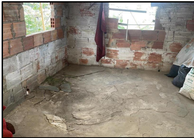
Figura 6. Hundimiento en placa de Cra. 17 #6-03
