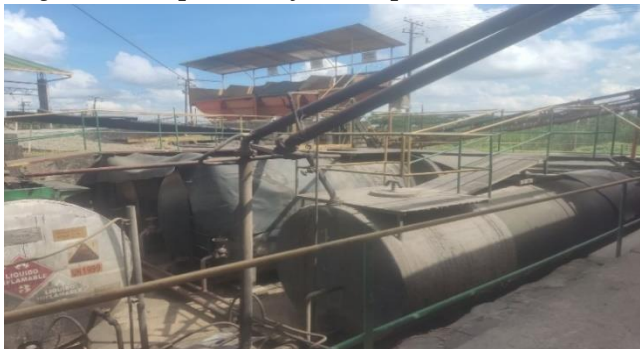
Figura 2 Tanques de asfalto empresa ECOBRAS S.A
