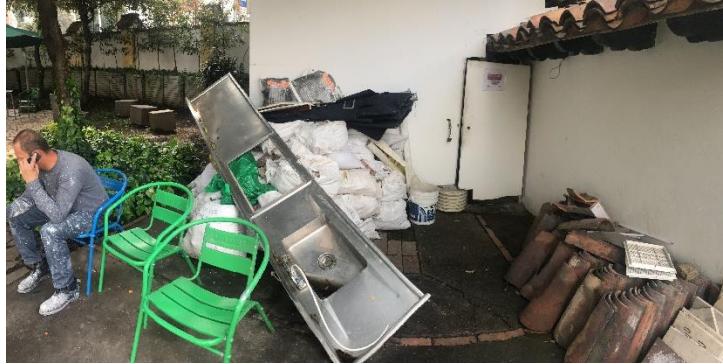
Imagen 6. Mala disposición de residuos sólidos de construcción.
