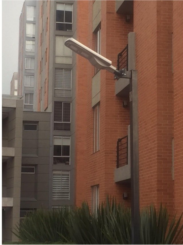
Figura 1. Luminaria con energía solar “todo en uno”
