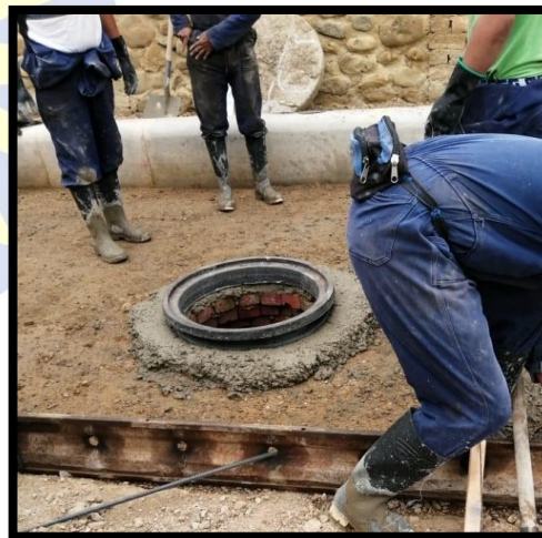
Ilustración 9: Visita Cra 1° Aro-tapa alcantarillado
