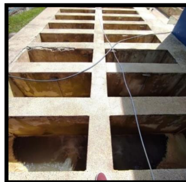
Ilustración 69: Planta de Tratamiento de Agua Potable PTAP
