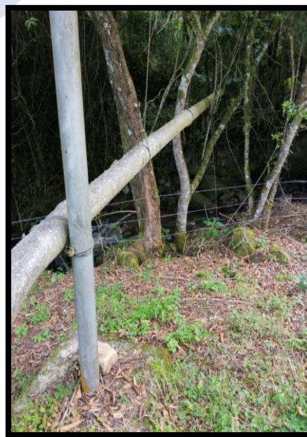
Ilustración 57: Línea de aducción Quebrada Única Paso elevado N° 2
