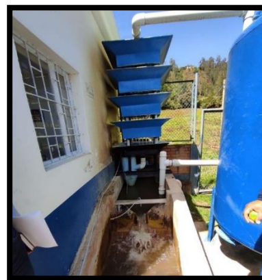
Ilustración 67: Planta de Tratamiento de Agua Potable PTAP
