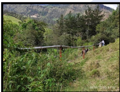
Ilustración 59: Línea de aducción Quebrada Única Paso elevado N° 4
