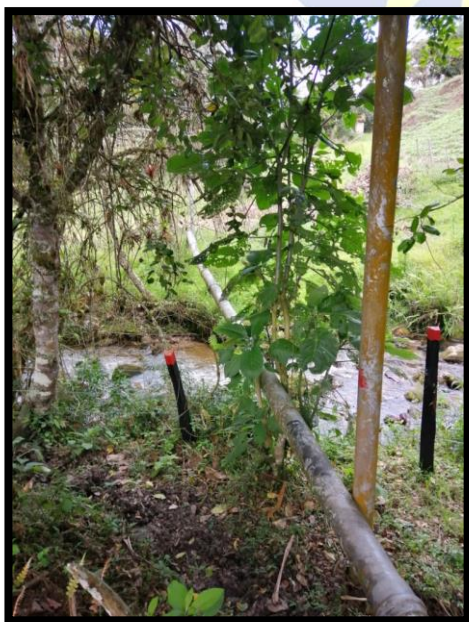
Ilustración 55: Línea de aducción Quebrada Única Paso elevado N° 1
