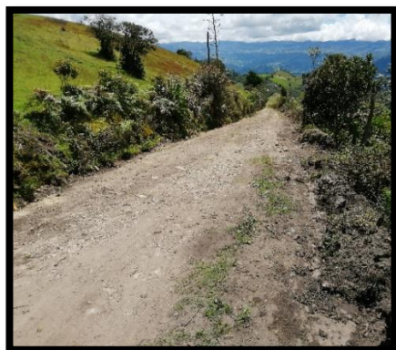
Ilustración 26: Reconocimiento del estado de vías rurales
