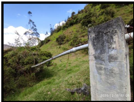
Ilustración 58: Línea de aducción Quebrada Única Paso elevado N° 3
