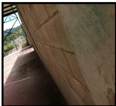
Ilustración 17: Visita C.I.C Estado de los muros
