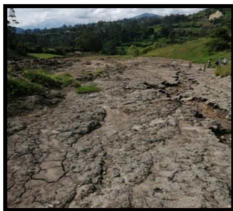
Ilustración 51: Acompañamiento a funcionaria de la gobernación en zona de deslizamiento
