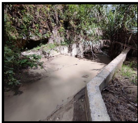
Ilustración 60: Línea de aducción Quebrada La Rosa Bocatoma
