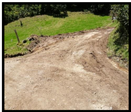
Ilustración 28: Reconocimiento del estado de vías rurales
