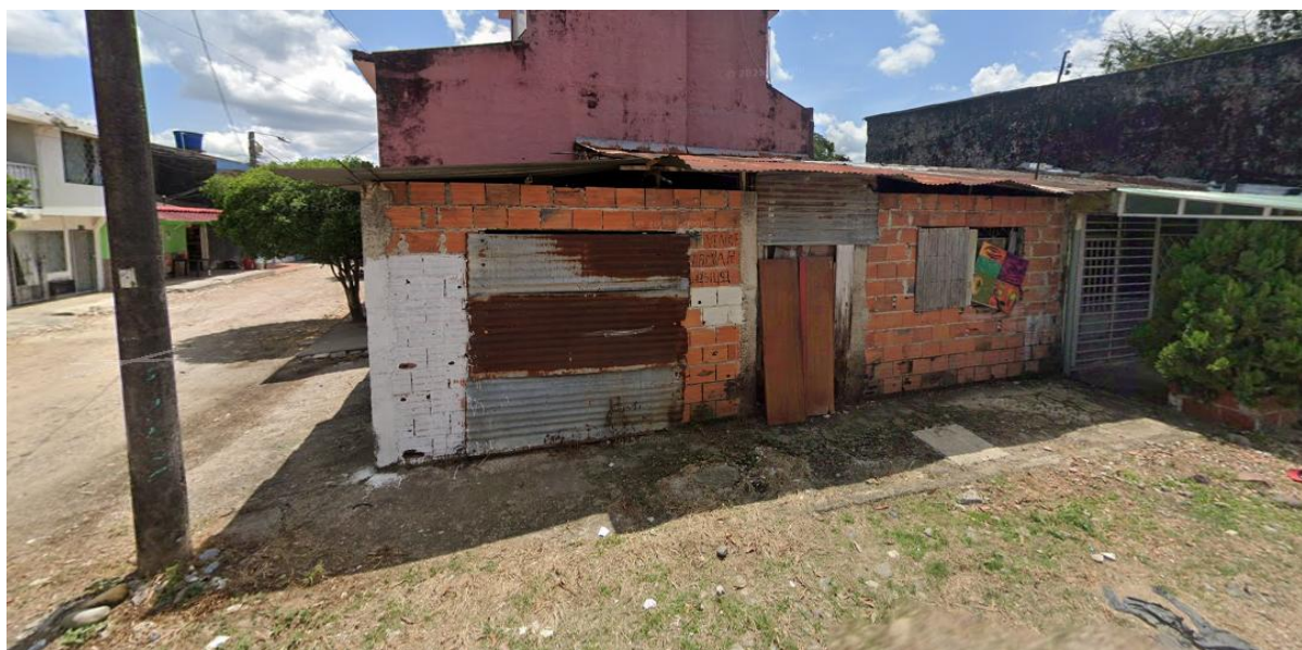
Figura 5. Vivienda que no cuenta con confinamiento, por autores, 2025.
