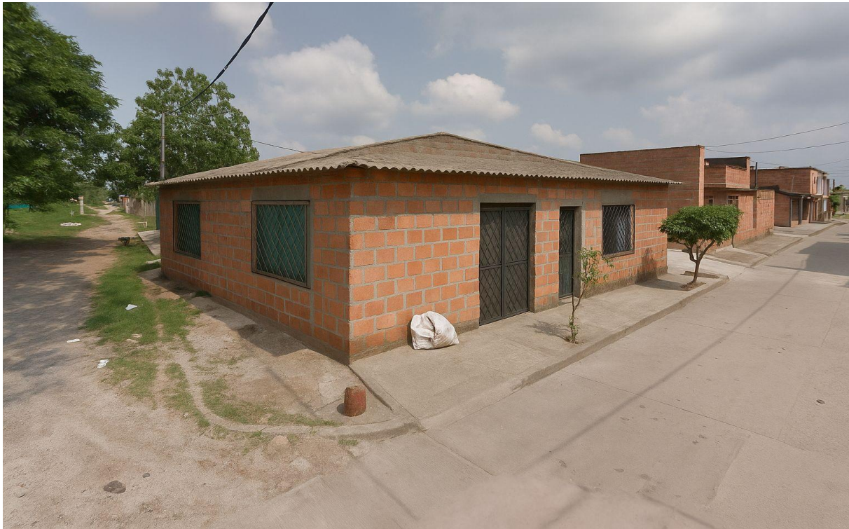
Figura 6. Vivienda que no cuenta con confinamiento, por autores, 2025.
