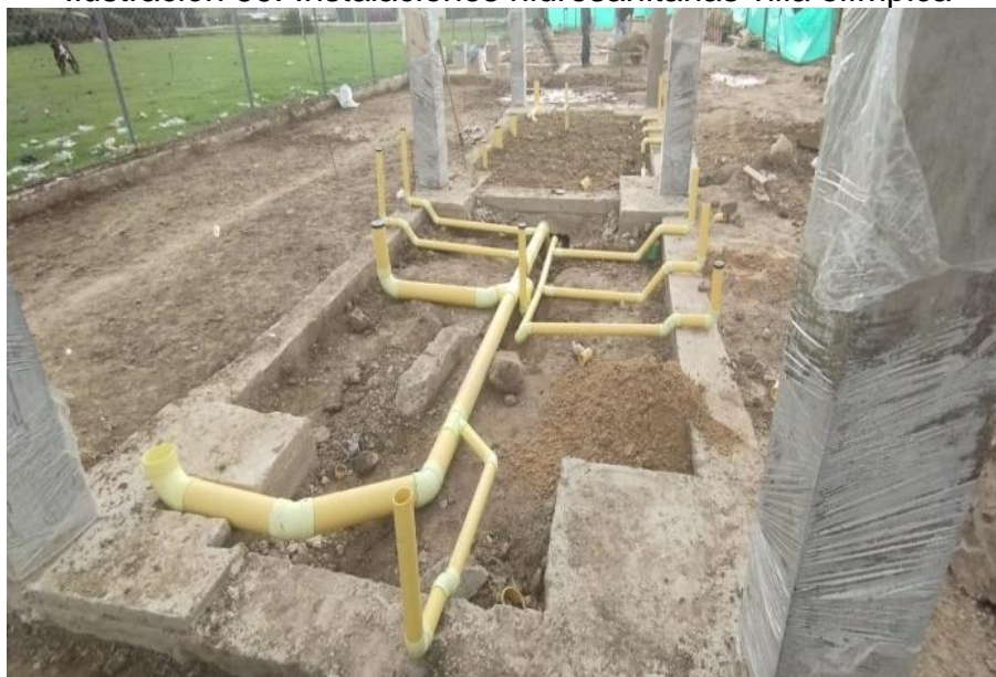
Ilustración 69. Instalaciones hidrosanitarias villa olímpica
