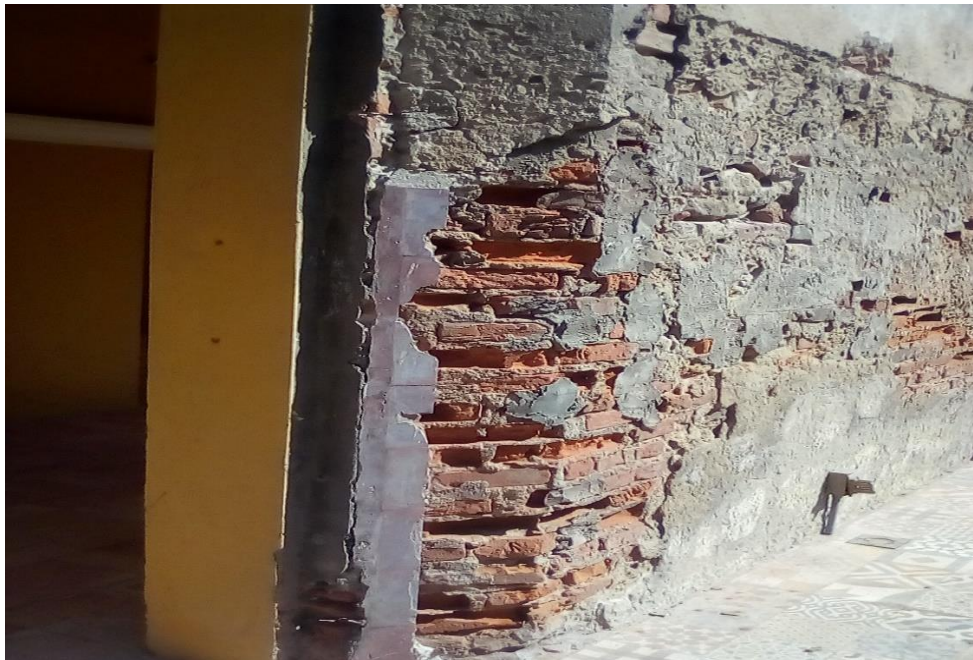
Figura 29. Desprendimiento del empañetado en el muro
