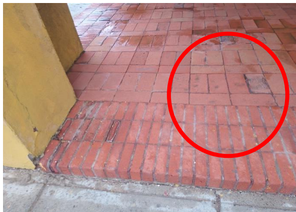
FOTOS-5 LESIONES EN PISO POR DESGASTE
