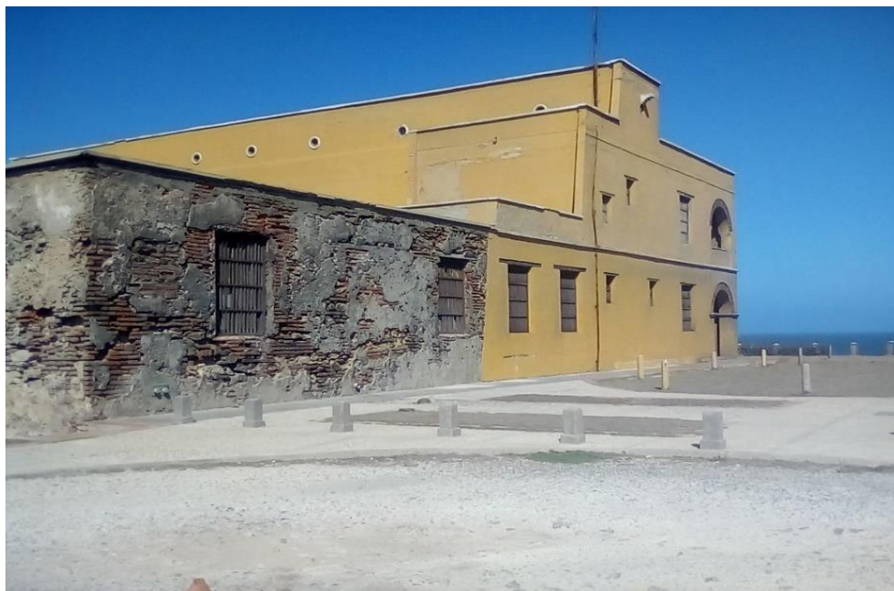
Figura 30. Otra toma del desprendimiento del empañetado en los muros
