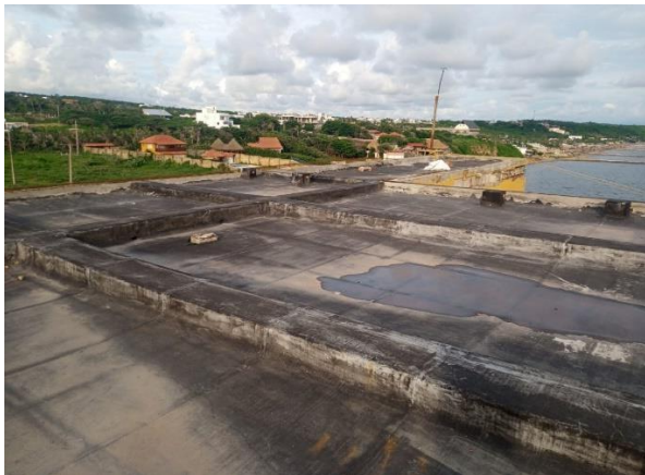
FOTOS-17 FILTRACIONES DE PLACA CUBIERTA
