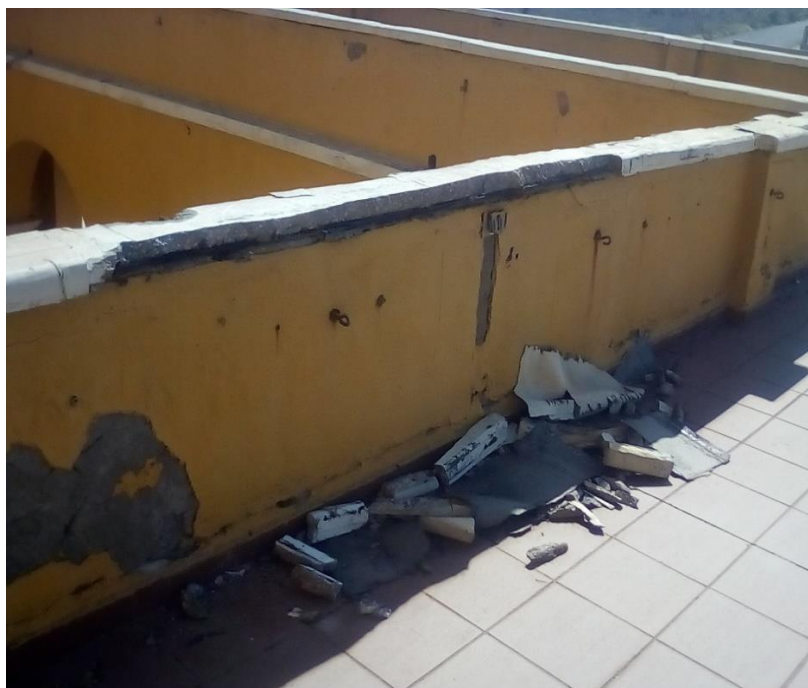
Figura 33. Figura 7, Desprendimiento del concreto que conforma las alfajías por acción del viento fuerte y la salinidad
