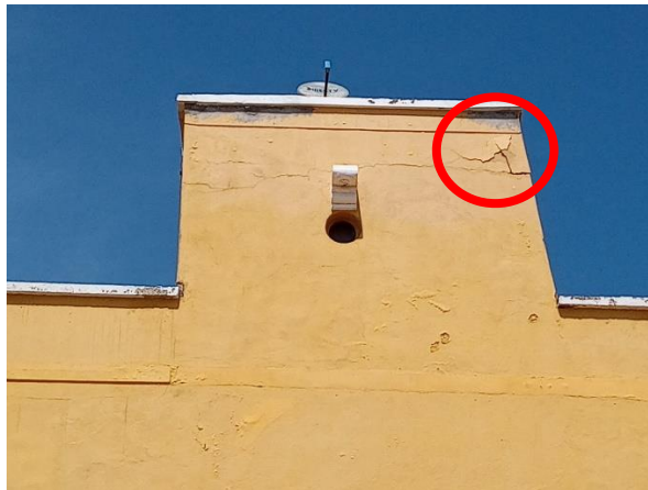
FOTOS-3 LESIONES EN FACHADA
