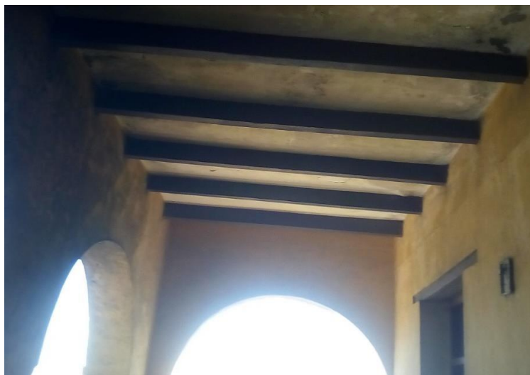
Figura 31. Estado del cielo raso interno (parte inferior de la losa entrepiso)
