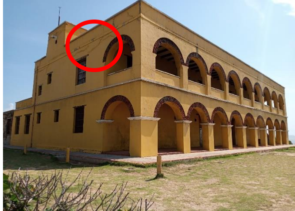
FOTOS-1 LESIONES EN FACHADA
