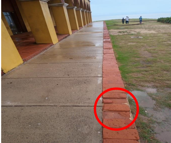
FOTOS-7 PISO CON DESGASTE ACCESO NORTE
