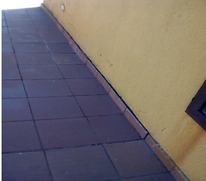
Figura 35. Estado del piso que adorna la estructura del paciente (castillo de salgar), nótese el desprendimiento de las fachaletas que conforman el zócalo del piso
