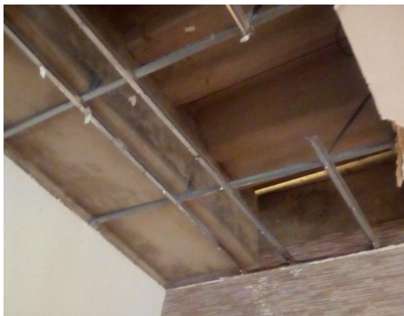
Figura 34. Desprendimiento del cielo raso y su estructura por acción del viento fuerte
