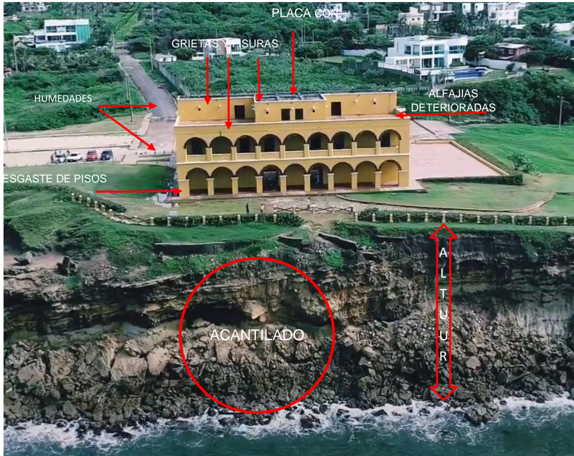
Imagen-Acantilado en deterioro altura con respecto al nivel del mar= 8.00M
