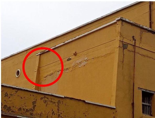
FOTOS-9 GRIETAS EN PLACA DE TERCER PISO
