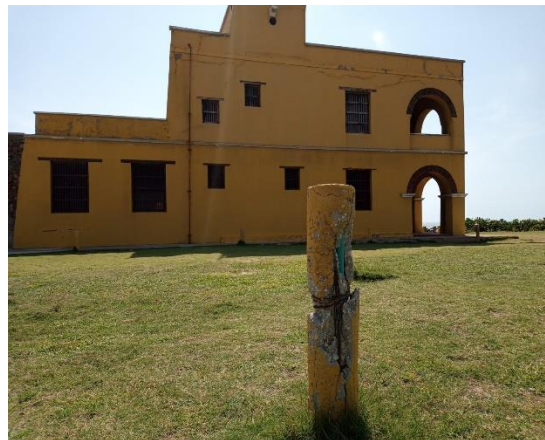
FOTOS-4 LESIONES EN FACHADA ORIENTAL
