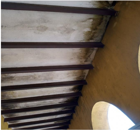
FOTOS-13 HUMEDAD BAJO PLACA
