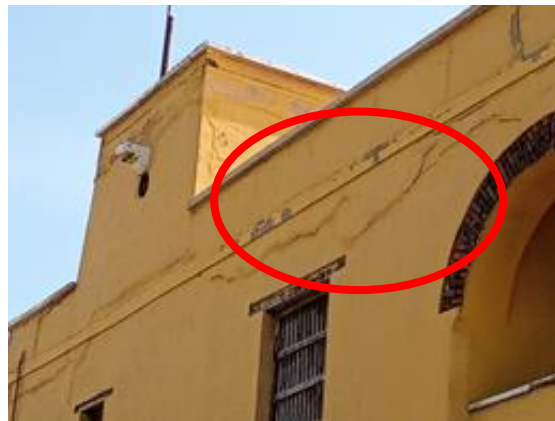
FOTOS-2 LESIONES DE HUMEDAD
