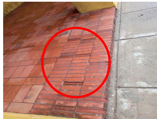
FOTOS-6 LESIONES EN PISO POR DESGASTE
