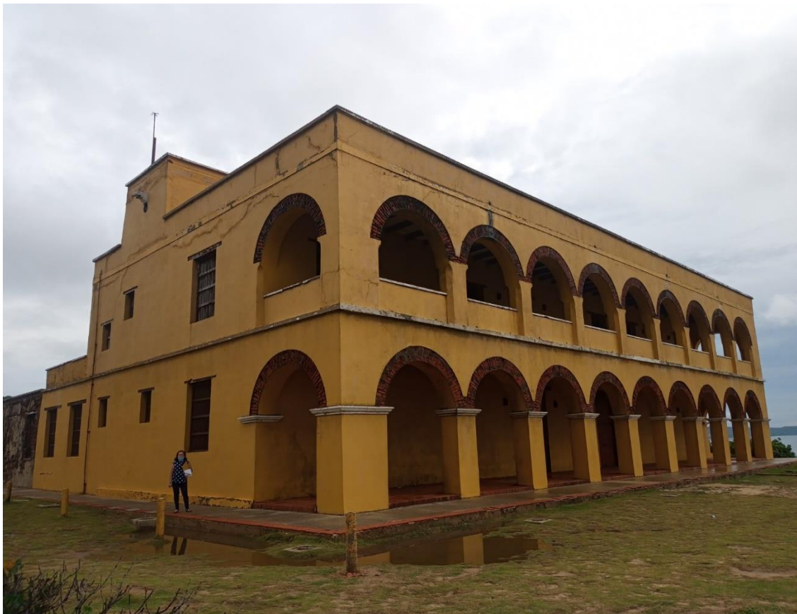
Imagen Propia – fachada Nororiental donde se observan las lesiones por ataques externos
