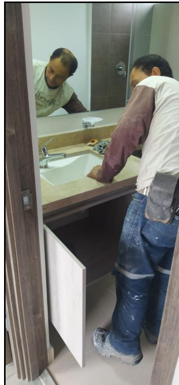
Ilustración 11 Revisión por parte de oficial
