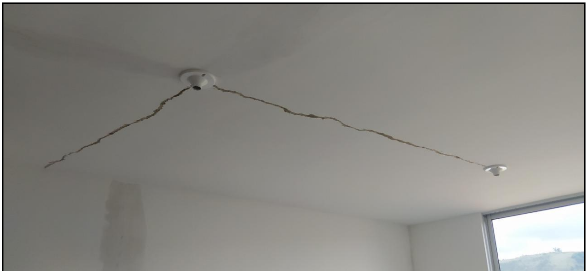
Ilustración 19 Grietas en techo
