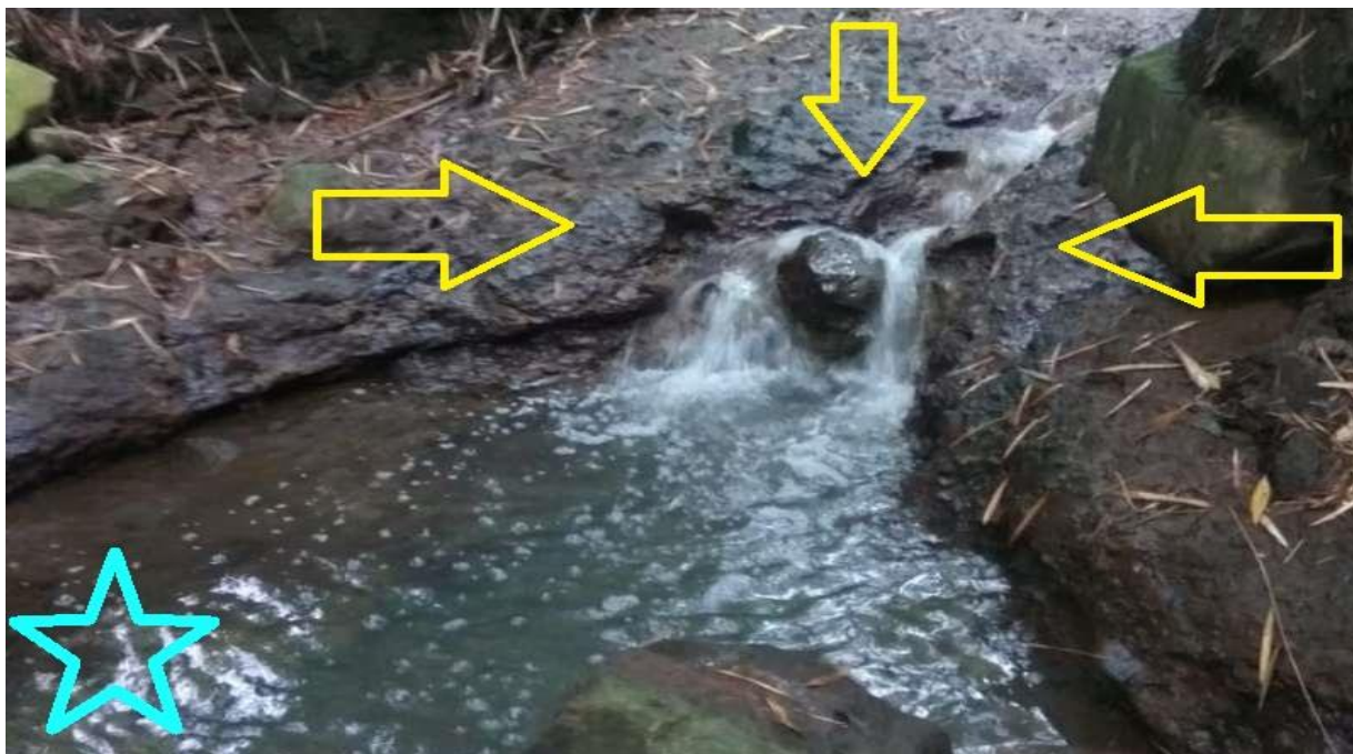
Imagen 3. Vertimiento de aguas servidas.
