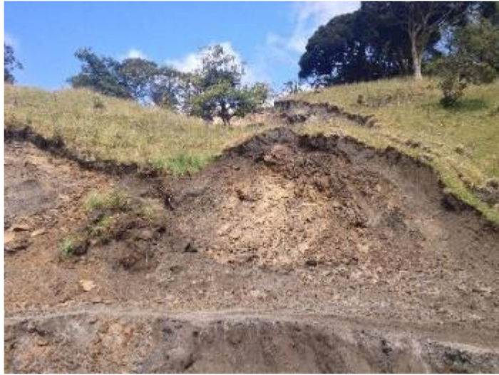
Figura 6. Deslizamientos de terrenos
