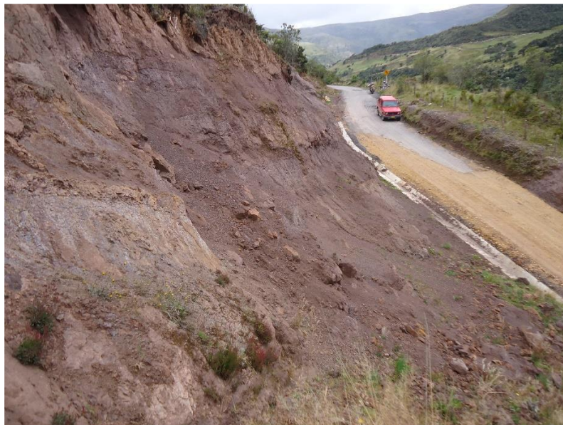
Figura 7. Perdida de talud
