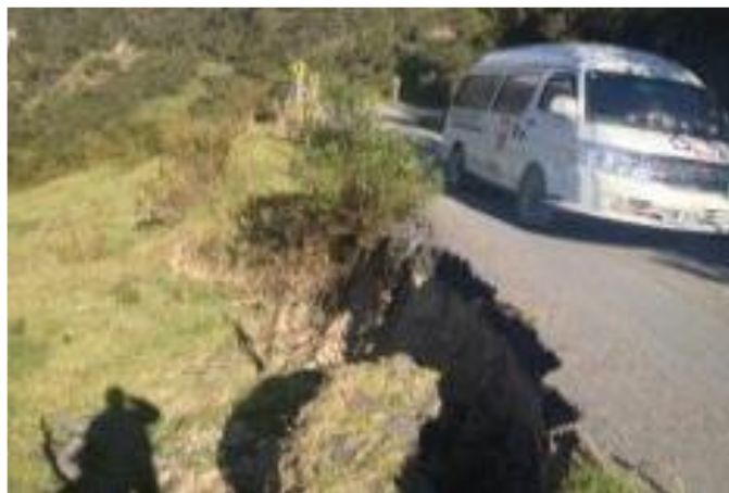
Figura 5. Perdida de banca de la vía
