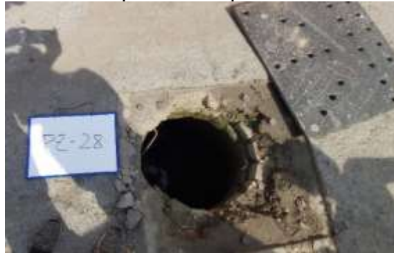
Fotografía 3. Pozo de inspección- tapa cuadrada en hierro fundido.
