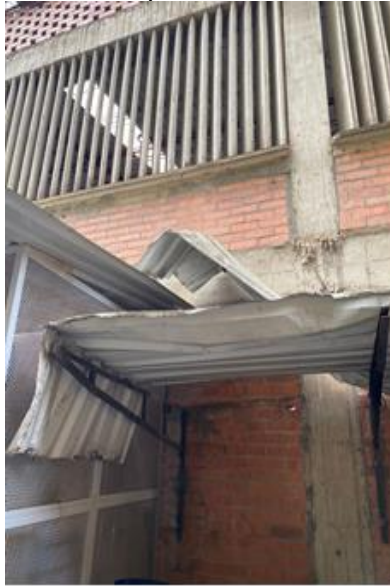
Figura 14. Techado de almacenamiento temporal de sustancias residuales peligrosas
