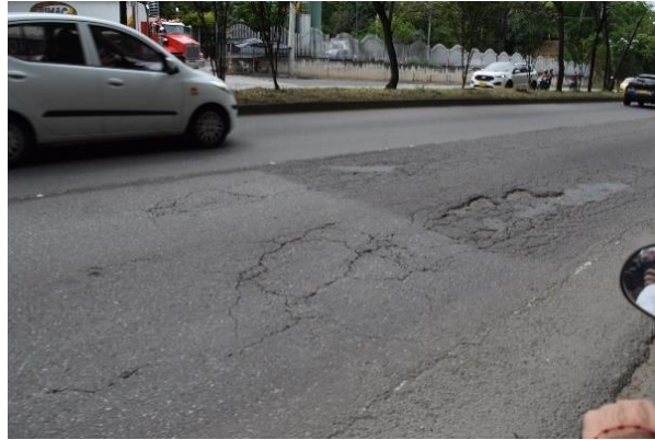
Figura 6. Estado del pavimento S-N.2
