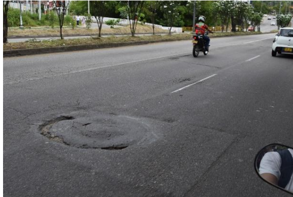
Figura 9. Estado del pavimento S-N.2
