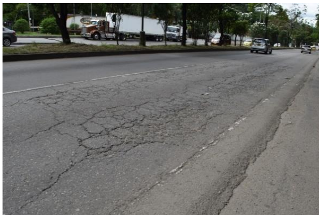
Figura 5. Estado del pavimento S-N
