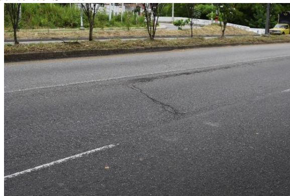
Figura 10. Estado del pavimento S-N.3
