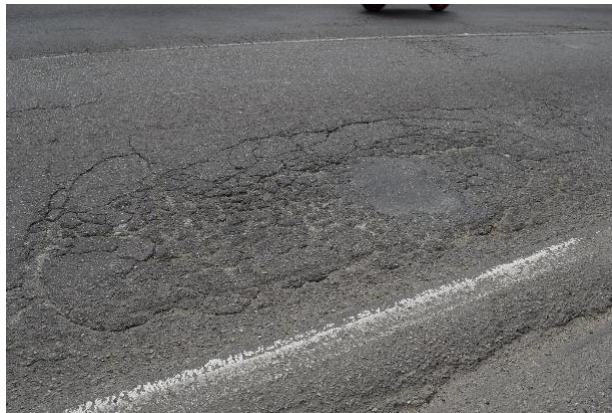
Figura 7. Estado del pavimento S-N.3
