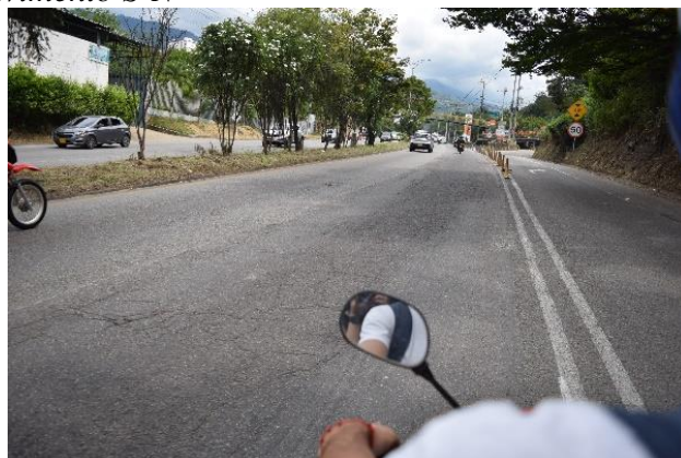
Figura 8. Estado del pavimento S-N
