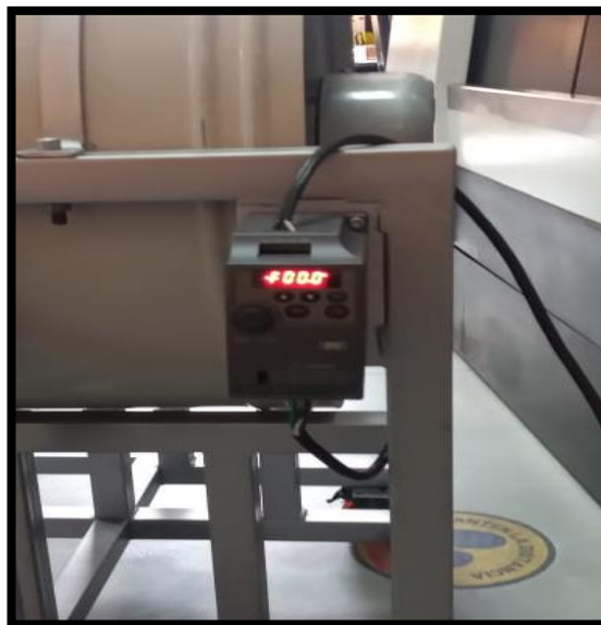
Figura 64. Variador de frecuencia conectado a la red eléctrica.
