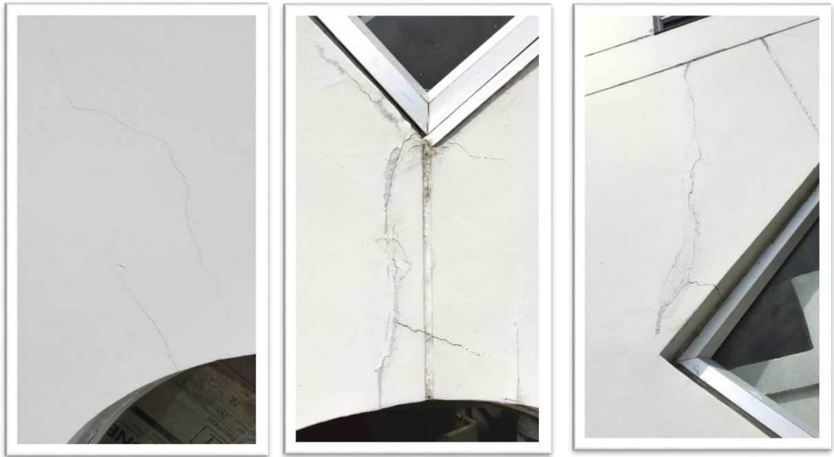
Figura 16. Grietas en los Muros de la Estructura. Tomada por el autor.
