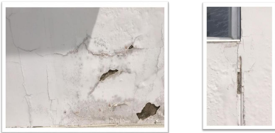
Figura 15. Grietas, Humedad y Otras Patologías en la Estructura. Tomada por el autor.
