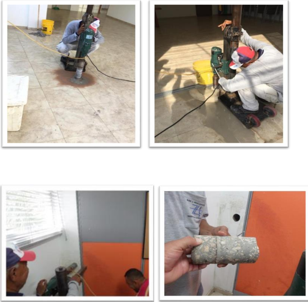
Figura 22. Extracción de Núcleos en Diferentes sitios de la estructura. Tomada por el autor.
