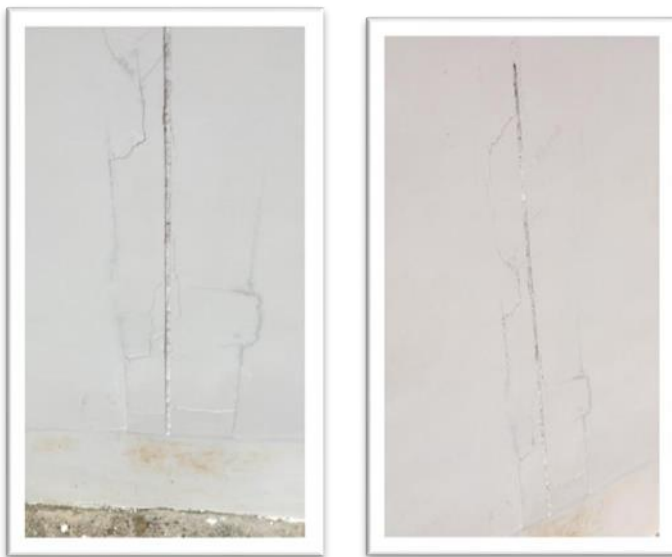
Figura 17. Fisuras en los Muros de la Fachada. Tomada por el autor.
