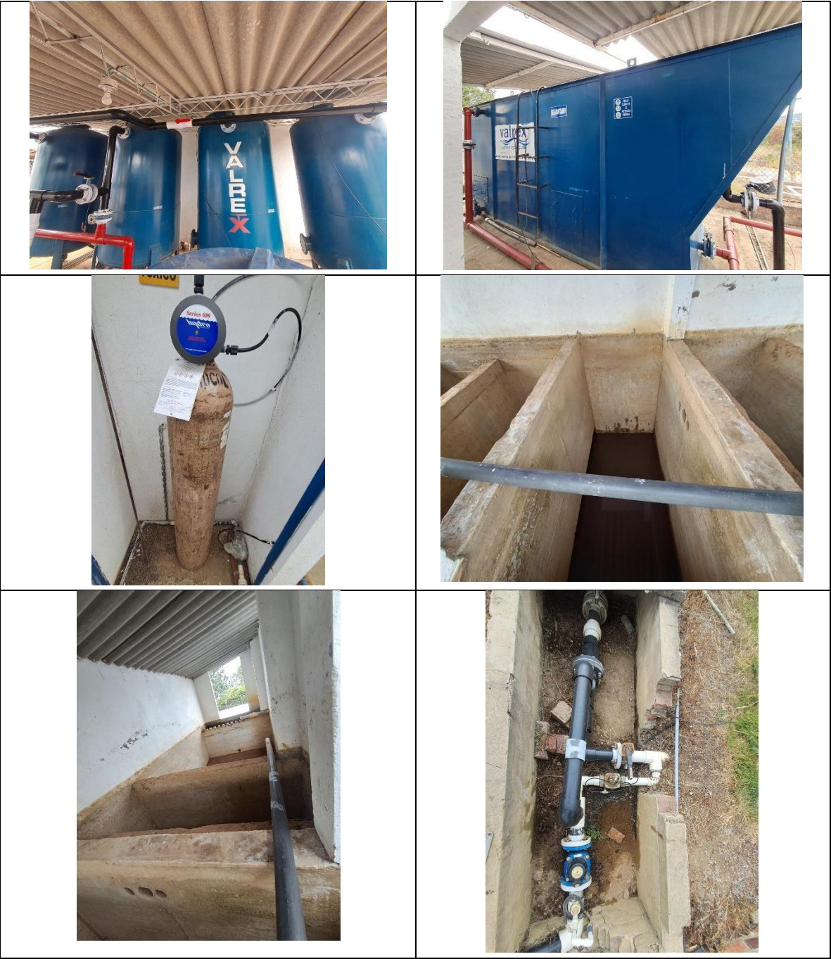
Ilustración 3 Registro Fotográfico de la PTAP de Tinjacá
