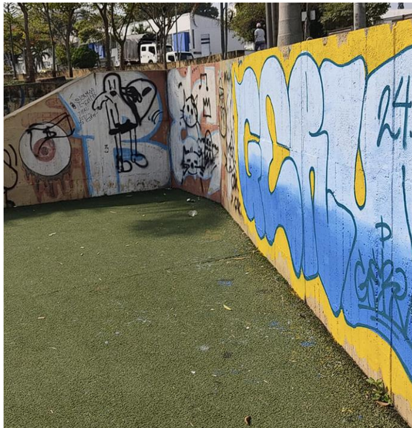
Figura 1. Muro de contención zona de los juegos para niños.
