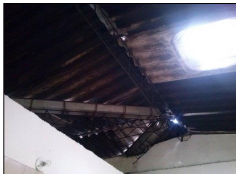
Ilustración 29. Cubierta en malas condiciones
