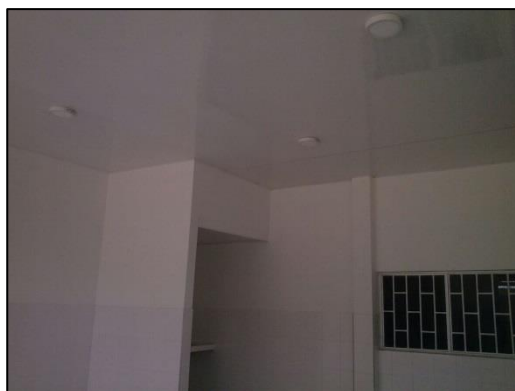
Ilustración 12. Interior de la instalación
