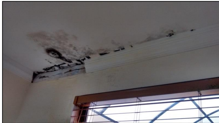
Ilustración 24. Presencia de hongos y desprendimiento de acabados
