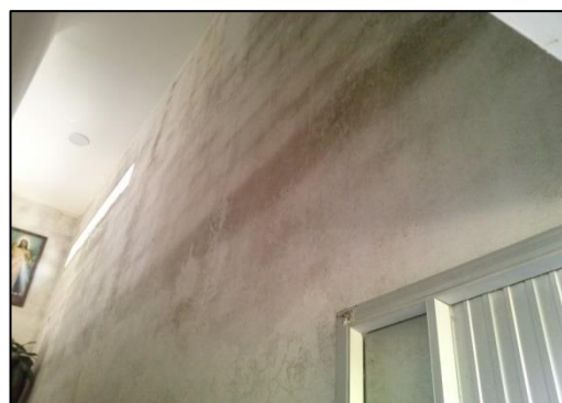
Ilustración 19. Humedad en muros
