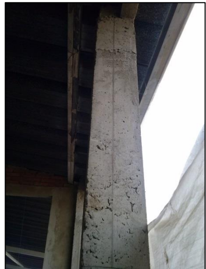
Ilustración 9. Patología en columna
