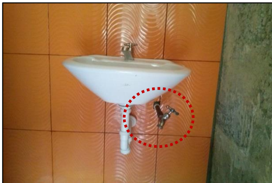
Ilustración 18. Falta de técnica en la ejecución
