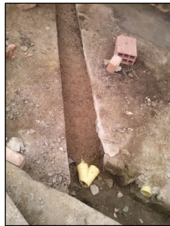
Ilustración 8. Tubería de desagüe
