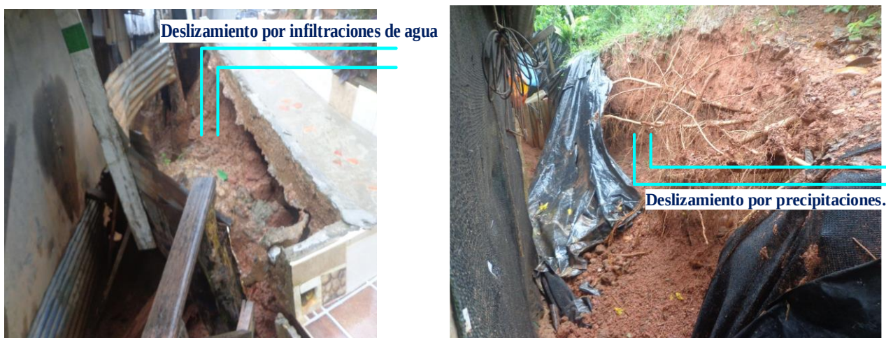
Ilustración 16. Deslizamientos por precipitaciones e infiltraciones hídricas. Fuente: Propia
