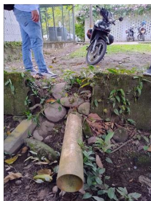
Figura 4.1.5 Estado de las tuberías
