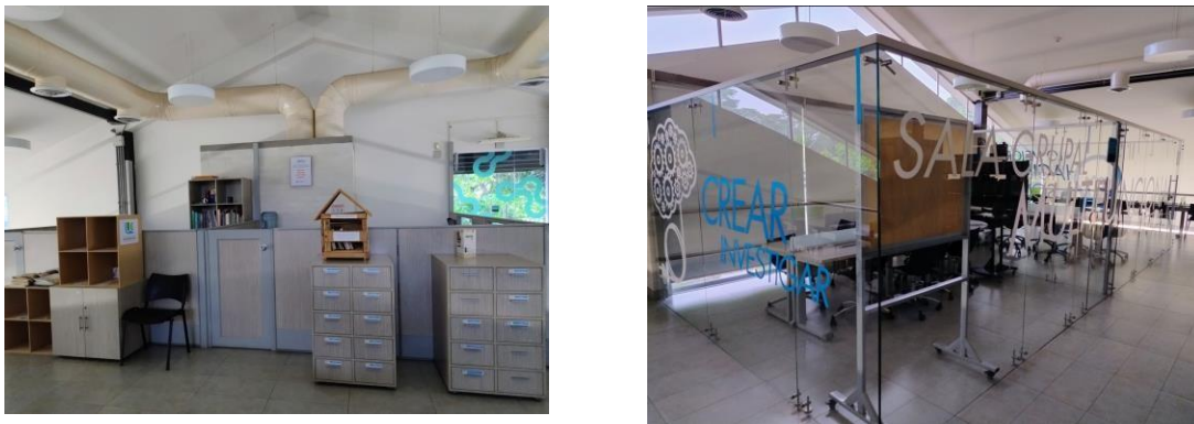
Figura 4.1.7 Detalle de ductos de aire acondicionado y cubículos de reuniones en el interior de la biblioteca
