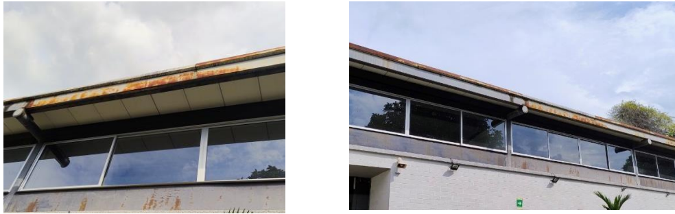
Figura 4.1.6 Deterioro superficial en la fachada
