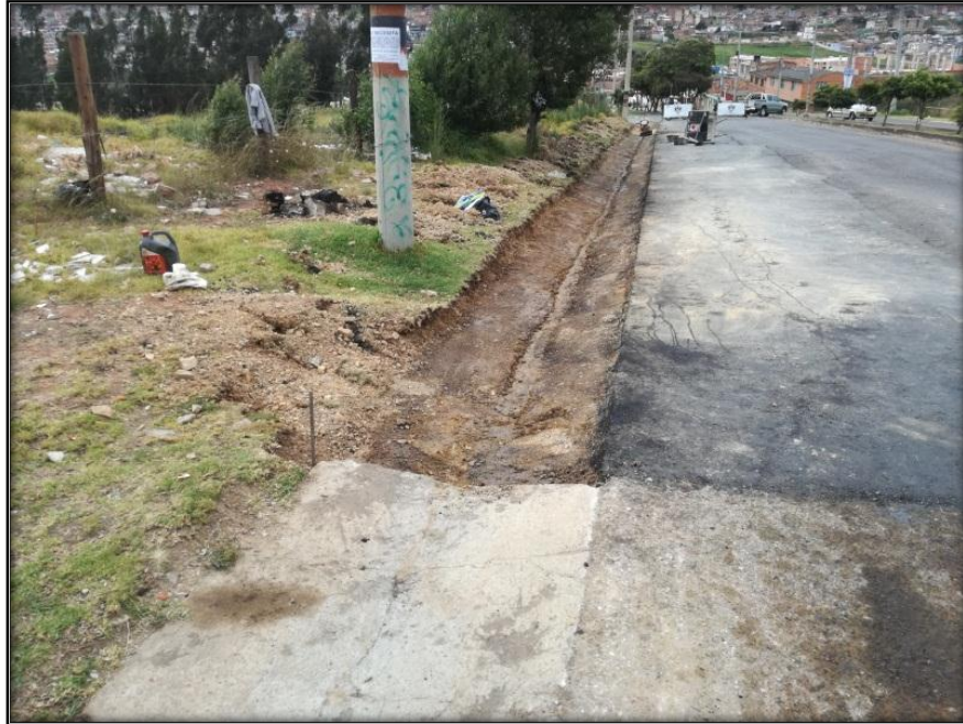
Imagen 16. Cuneta en el barrio Xativilla
