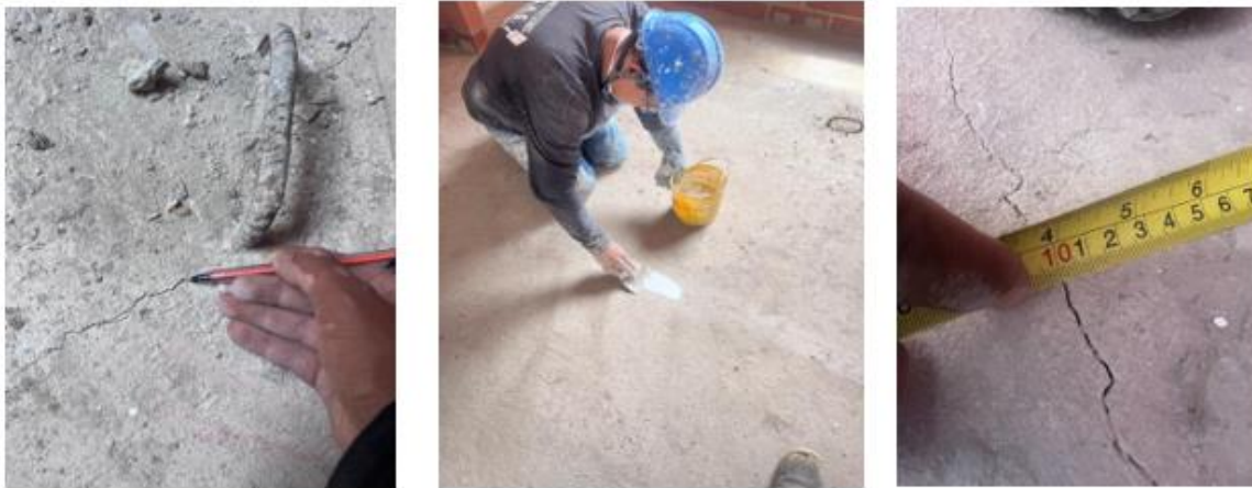
Figura 10 Control de fisuras con testigos
