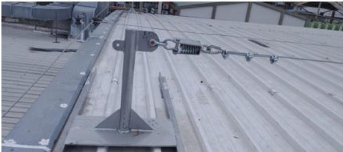
Figura 39. Sistema absorbedor instalado 1.
