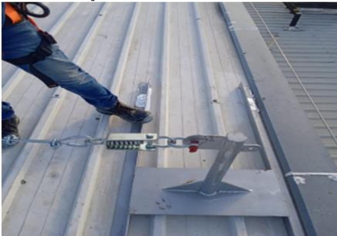
Figura 40. Sistema absorbedor instalado 2.
