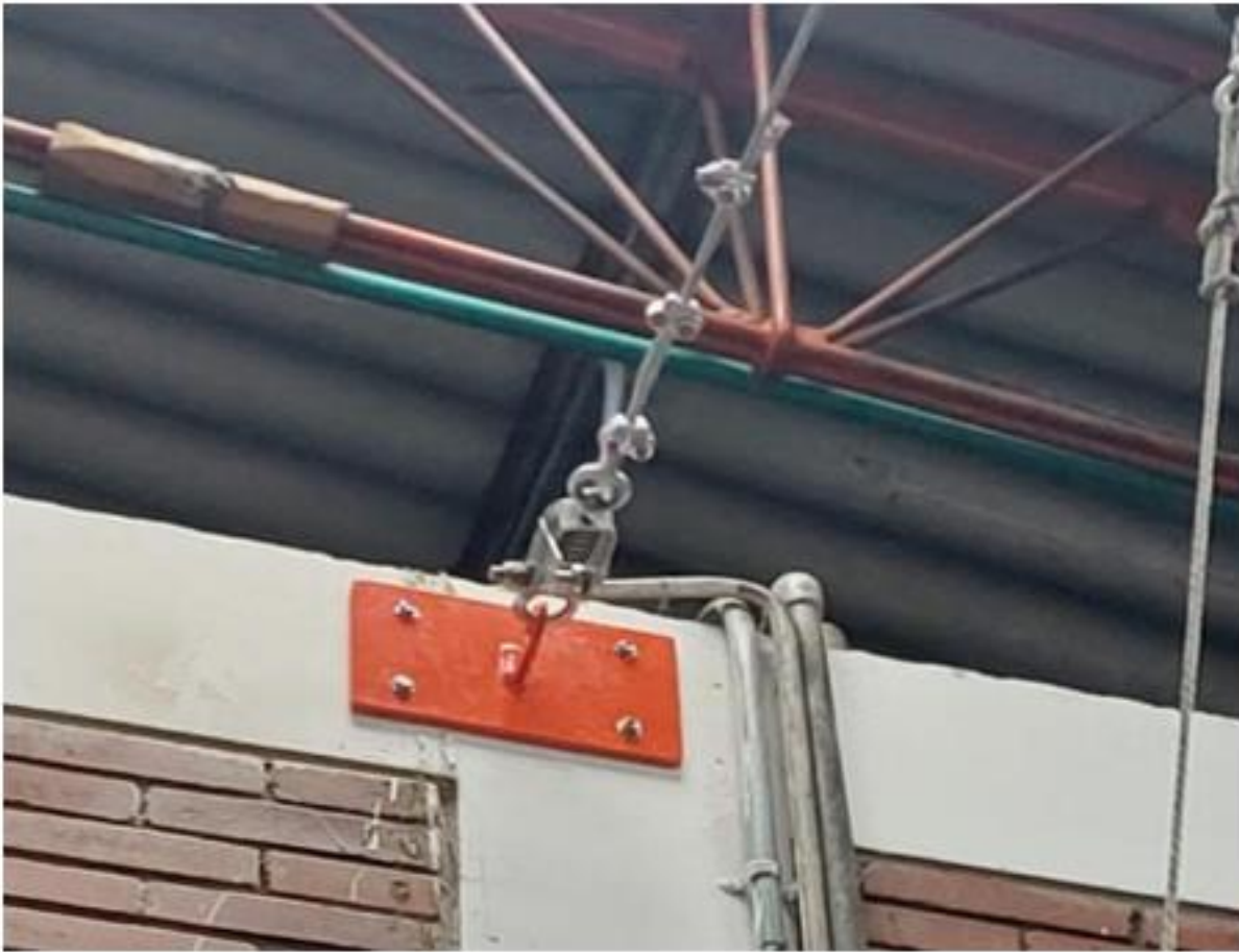
Figura 41. Sistema absorbedor instalado 3.
