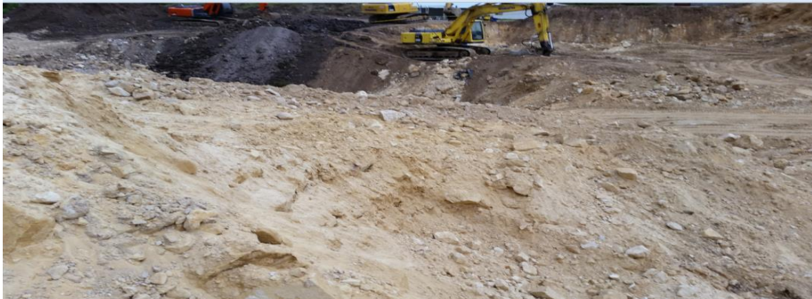
Figura 94. preparación del terreno para la conformación de los terraplenes que soporten la onda de choque producida por las voladuras. Fuente: Elaboración Propia.
