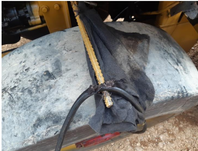
Fig. 52- Cable dañado de vibro compactador.
