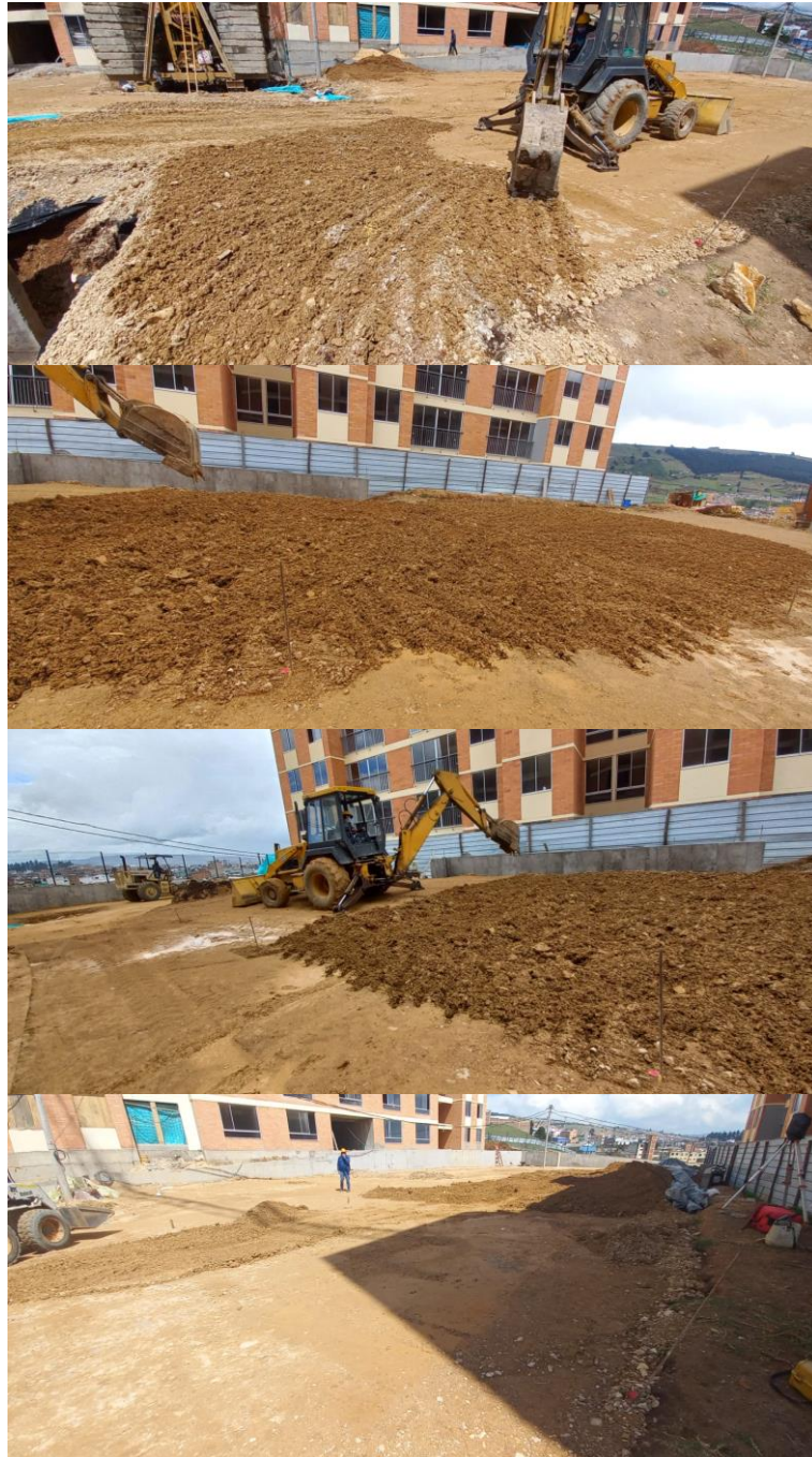
Figura 13. Escorificación de zonas acolchonadas en Sub base granular
