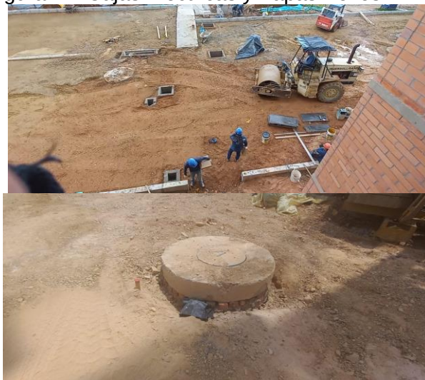
Figura 21. Cajas Eléctricas y Tapas Pozos
