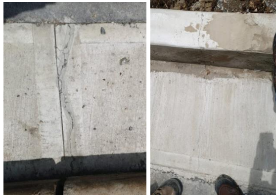
Figura 52. Borde derecho PR 0+197 fisura tramo 1 y fisura por no dilatación PR 0+124 tramo 2.
