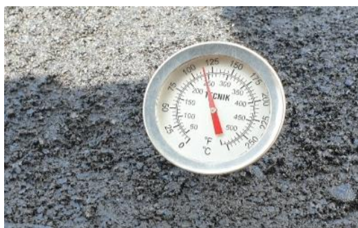
Figura 39. Control de temperatura.
