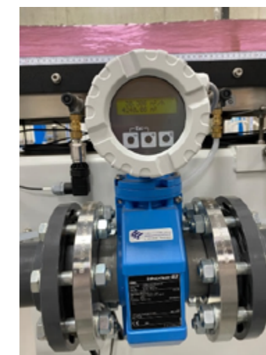
Imagen 112. Caudalímetro. Fuente: Elaboración propia.
