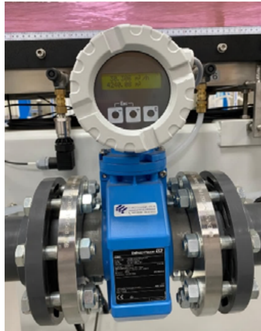
Imagen 89. Caudalímetro. Fuente: Elaboración propia.
