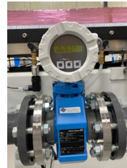
Imagen 136. Caudalímetro. Fuente: Elaboración propia.
