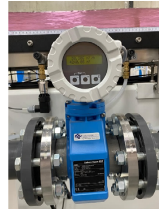
Imagen 72. Caudalímetro. Fuente: Elaboración propia.
