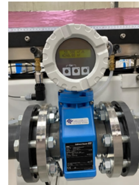
Imagen 124. Caudalímetro. Fuente: Elaboración propia.
