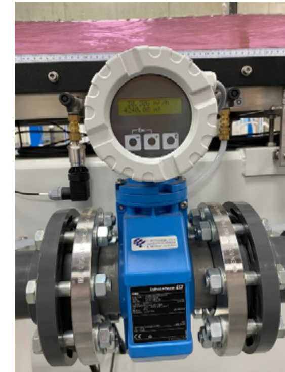
Imagen 39. Caudalímetro. Fuente: Elaboración propia.
