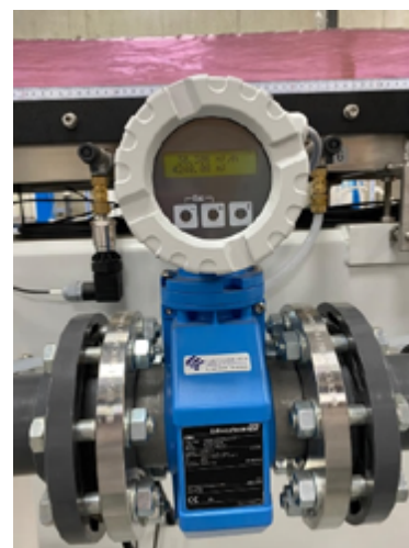
Imagen 55. Caudalímetro. Fuente: Elaboración propia.
