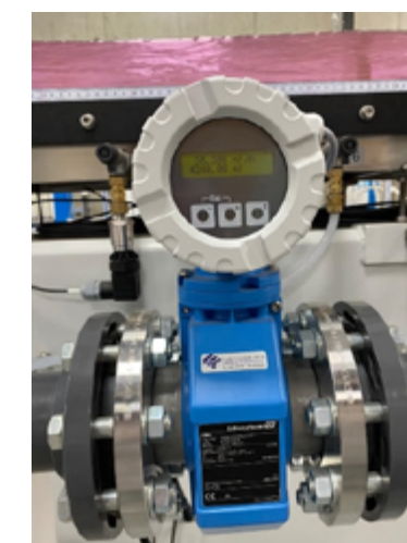
Imagen 101. Caudalímetro. Fuente: Elaboración propia.
