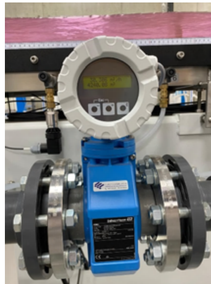
Imagen 166. Caudalímetro. Fuente: Elaboración propia.
