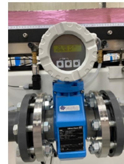
Imagen 148. Caudalímetro. Fuente: Elaboración propia.
