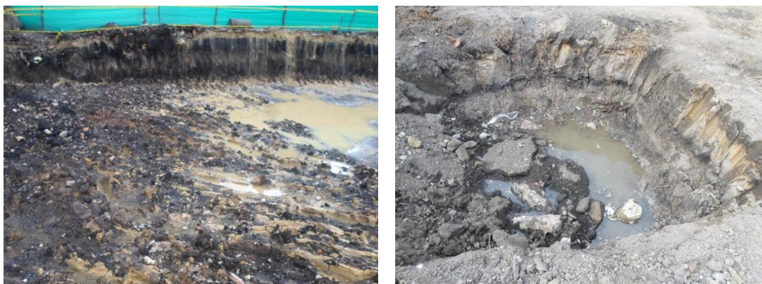
Figura 35. Patología relevante/Fuente propia
