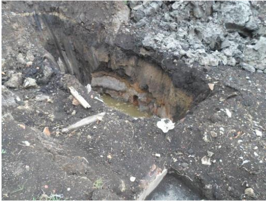
Figura 68. Inspección 1-Filtración de agua
