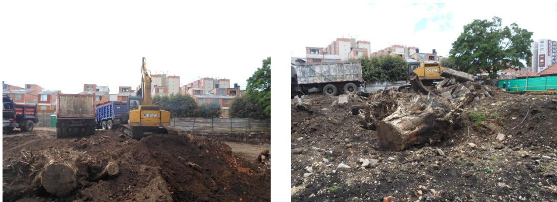
Figura 65.Raicesde arboles encontradas en excavacion/Fuente propia
