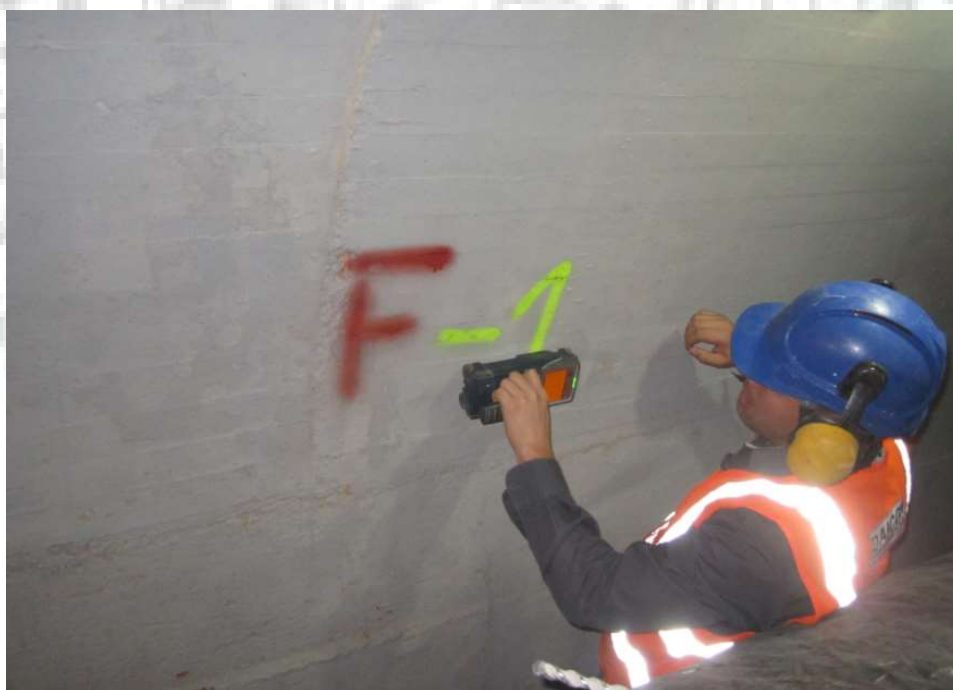
Fotografía. 143. Detección acero de refuerzo en túnel de descarga. Fuente: Consorcio Embalses CAR, 2020.
