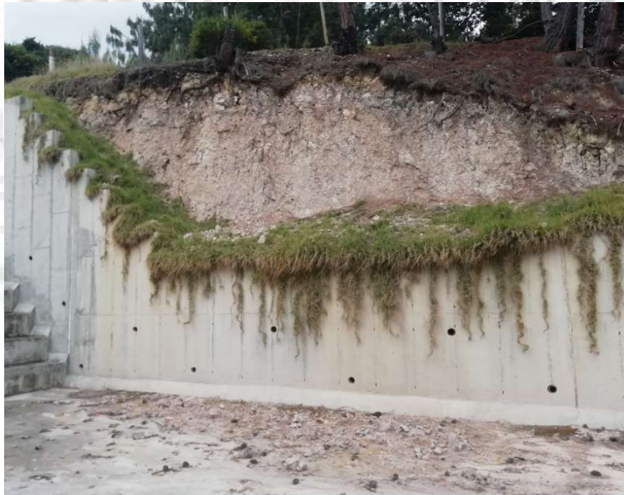
Fotografía. 131. Inestabilidad del talud del margen izquierdo del vertedero. Fuente: Consorcio Embalses CAR, 2020.
