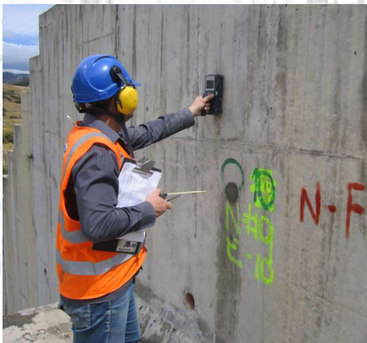
Fotografía. 138. Detección acero de refuerzo en muro del vertedero.
