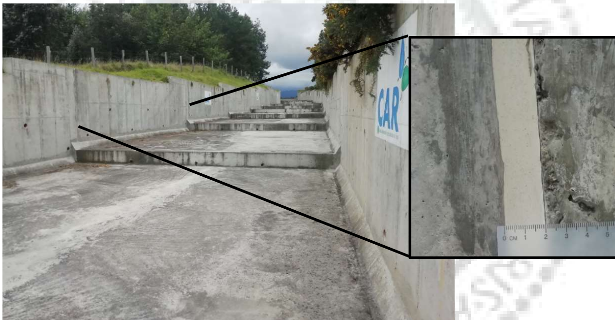
Fotografía. 128. Estado general del material de sello de la junta. Fuente: Consorcio Embalses CAR, 2020.
