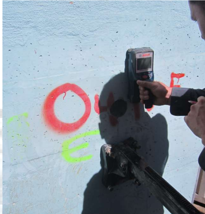
Fotografía. 146. Detección acero de refuerzo caseta de máquinas.
