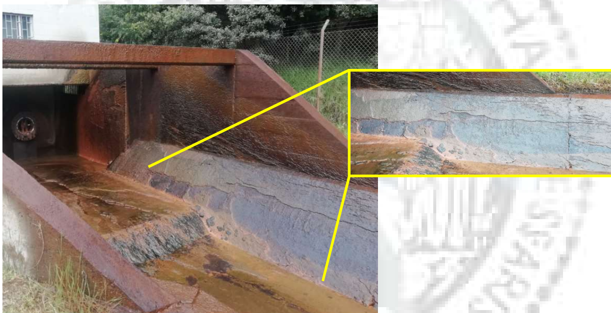
Fotografía. 125. Presencia de desgaste del concreto por abrasión.
