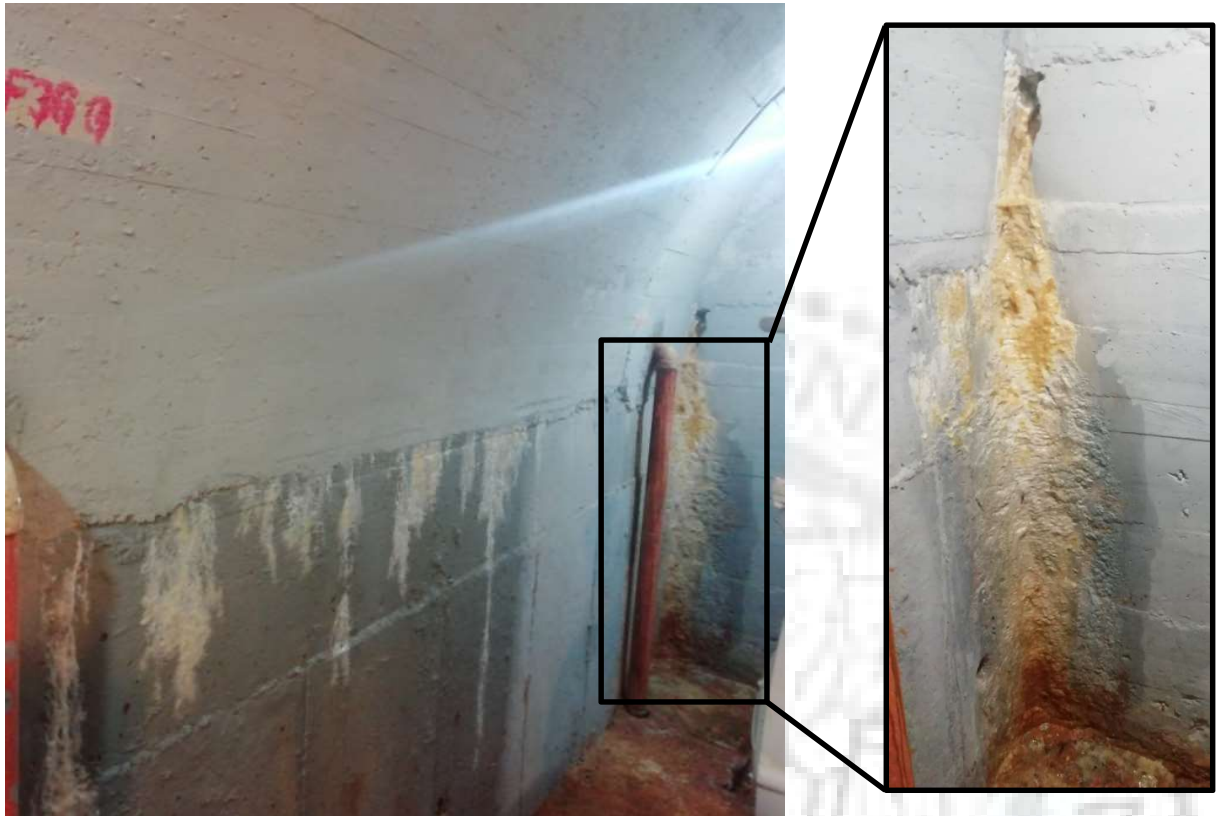
Fotografía. 118. Presencia de eflorescencias en el tapón de salida.
