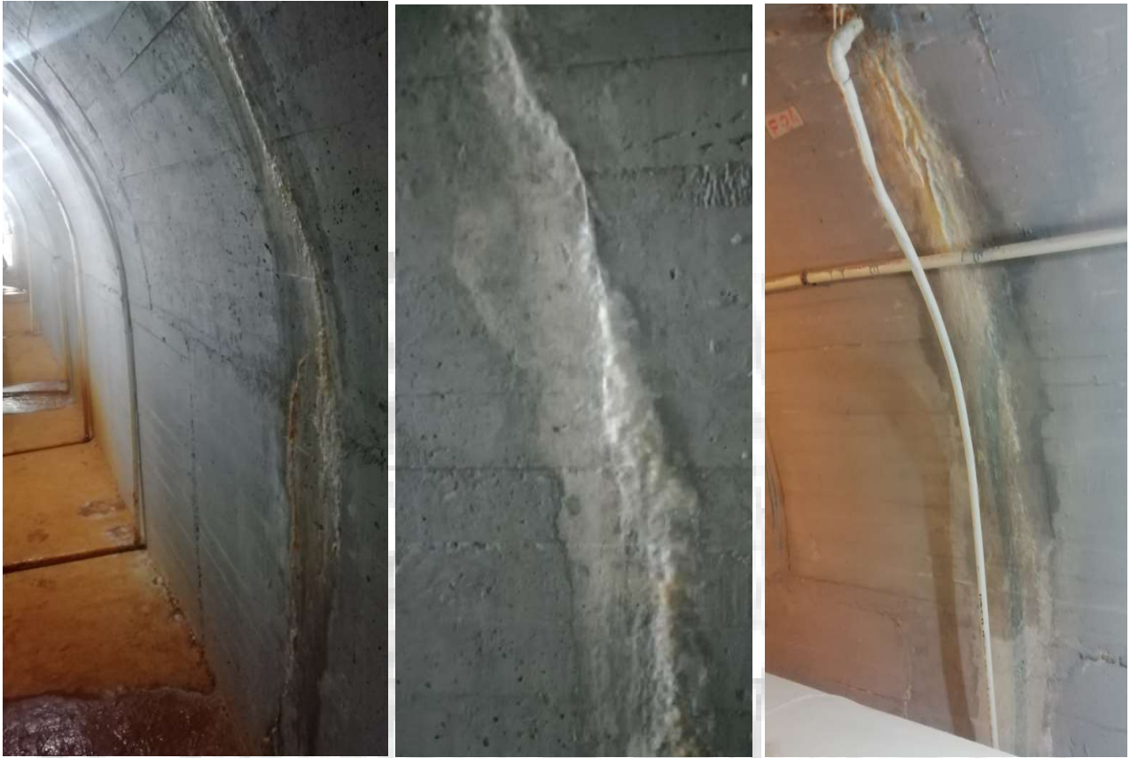
Fotografía. 119. Presencia de eflorescencias juntas verticales.
