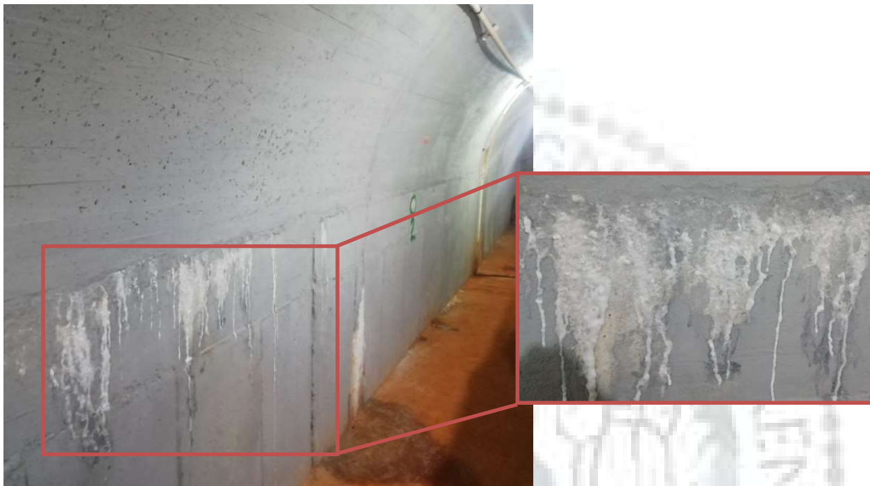
Fotografía. 121. Presencia de eflorescencias juntas horizontales.
