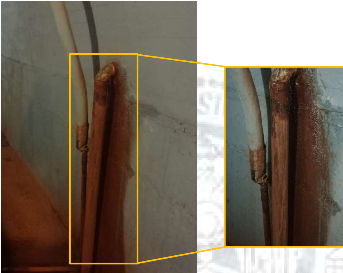
Fotografía. 120. Presencia de escurrimientos color marrón.
