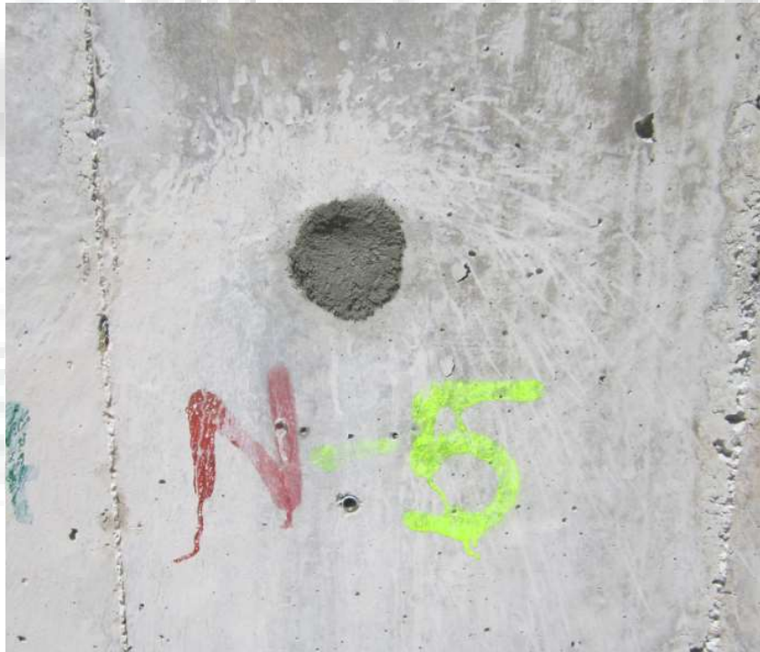
Fotografía. 137. Reparación típica de los núcleos extraídos. Fuente: Consorcio Embalses CAR, 2020.
